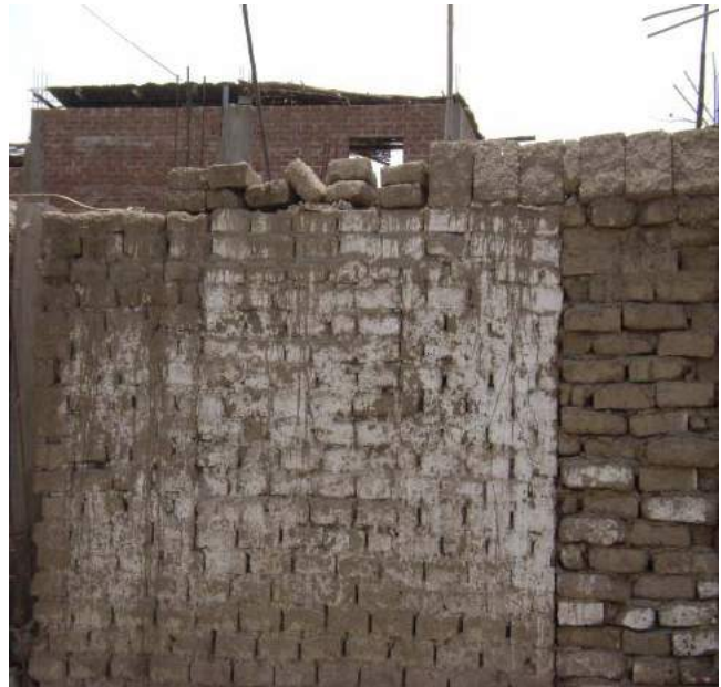
Muro construido sin Asistencia Técnica
