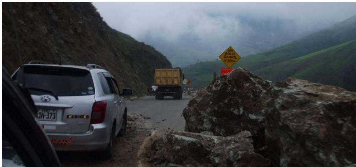
Fotografía N° 19: Afectación de la ruta 10A (Trujillo – Otuzco) debido a deslizamientos o derrumbes – Equipo SIRAD Trujillo 2012
