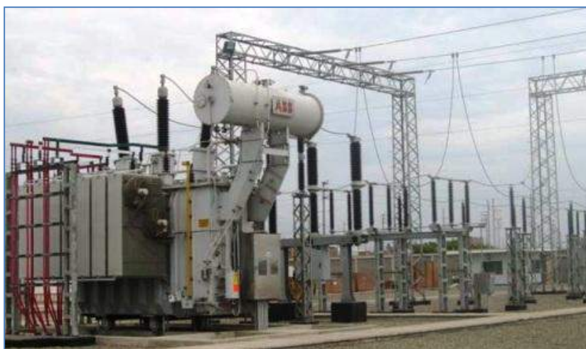
Fotografía N° 15: Subestación de Transformación eléctrica Noroeste - Trujillo
