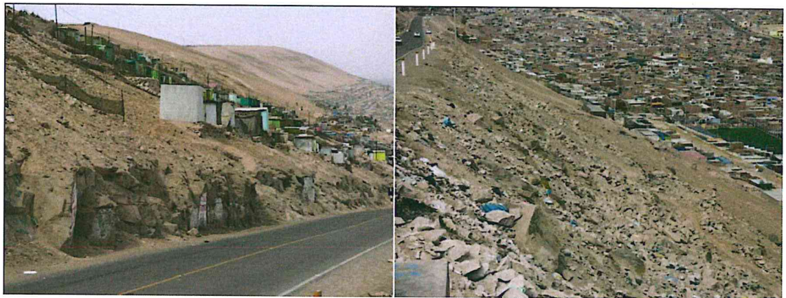
Foto 5. Caída de rocas en la Asociación de Vivienda Villa Intiorko, en caso de sismos las pircas y los bloques suspendidos en las laderas del cerro Intiorko pueden ceder y afectar a las viviendas que se encuentran en la parte inferior.
