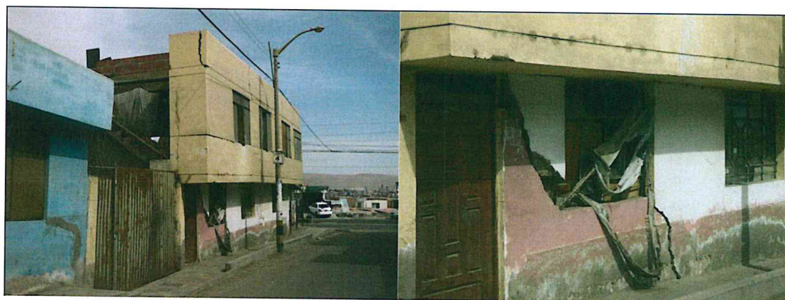
Foto 4. Viviendas de la Asociación de Vivienda La Florida afectada por el sismo del 2001, como se puede apreciar aún se aprecian los agrietamientos en las viviendas.
