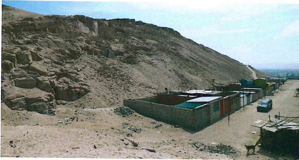
Foto 10. Caída de rocas y derrumbes en forma de canchales de detritos arriba de viviendas de la Asociación de Vivienda La Florida, en la margen izquierda de la quebrada del Diablo.
