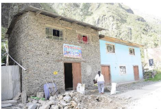
Vivienda sin sobre cimentación, sin columnas, ni vigas de soporte.
