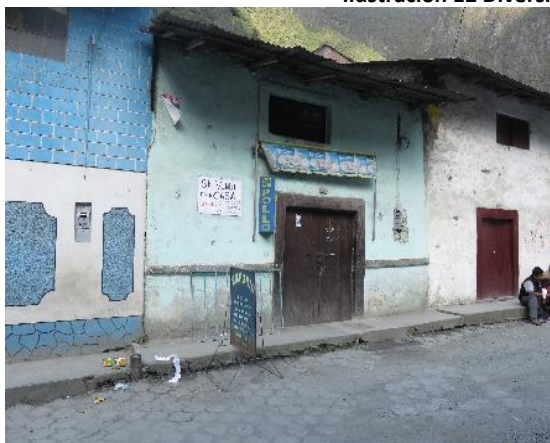
Mala construcción de adobe en el sector
