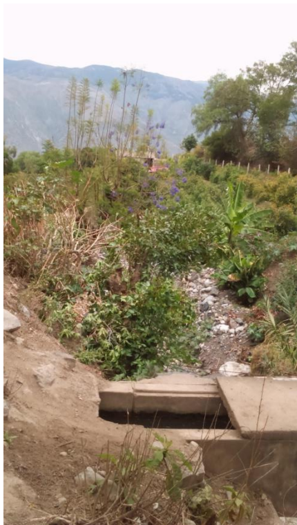
a): Infraestructura de Riego (canal de riego de concreto).
