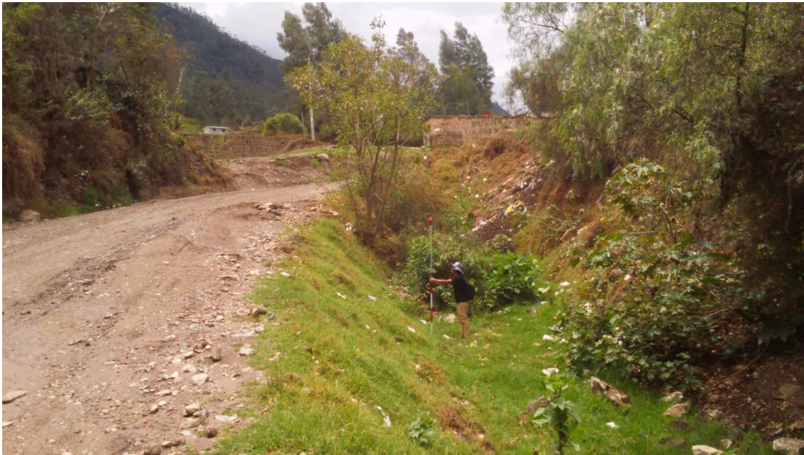
Cauce de la quebrada estrechado por vía pública y acumulación de material de desmonte.
