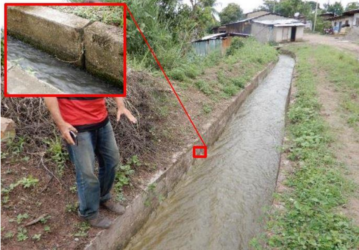
Figura 24. Vista del canal de riego El Campesino del centro Poblado El Tigre.
