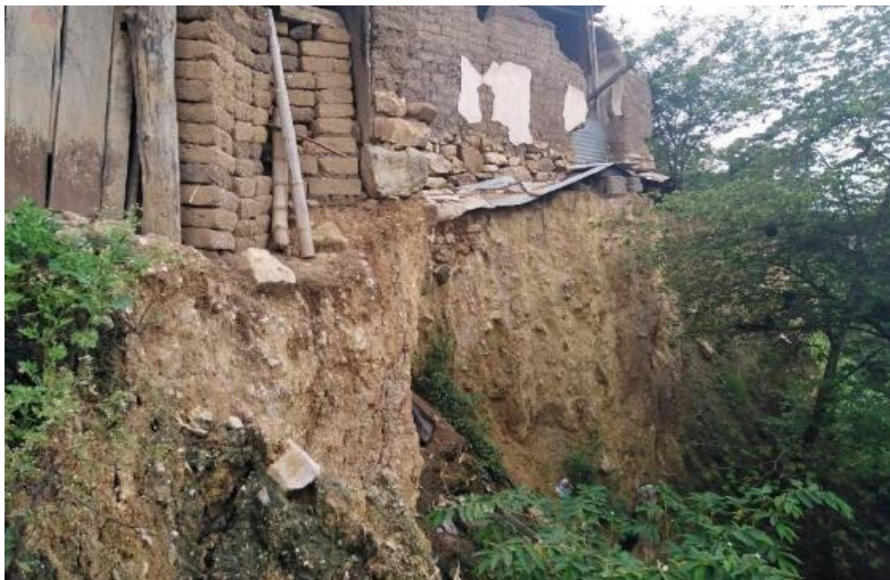
Fotografía 04. Cortes de talud expuestos debido a los deslizamientos en el área urbana.
