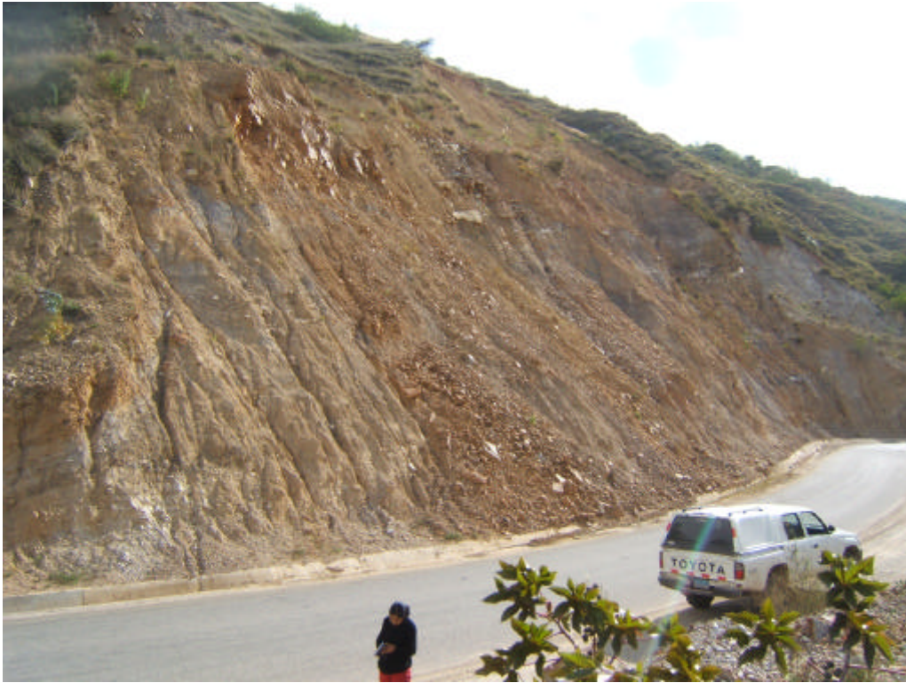
Foto 23 Derrumbe en el sector de quebrada Chulucana, que afecta tramo de carretera Cajamarca-San Marcos.
