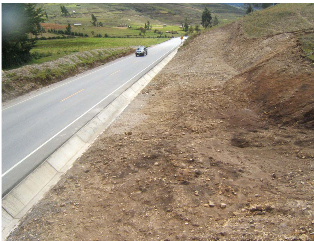
Terrazo o banqueteo de talud afectado por deslizamiento en un sector de la carretera entre Cajamarca y La Encañada.
