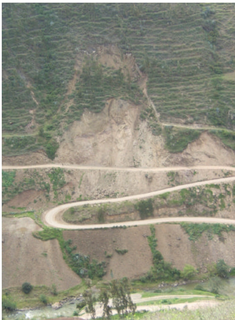
Foto 25 Deslizamiento traslacional en el sector de Bambamarca, comprometiendo dos desarrollos de carretera.
