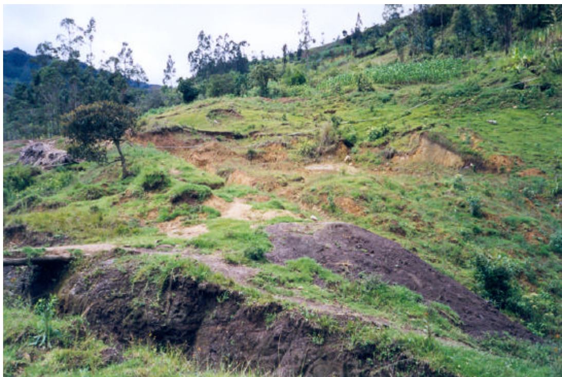
Foto 55 Vistas de los deslizamientos de Cascadén (foto superior) y Pulán (vista inferior), que afectan áreas de cultivo.
