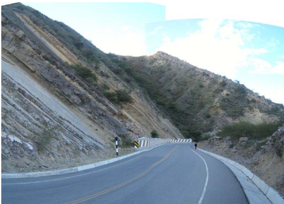
Muro cíclopeo para contención de material caído por deslizamiento planar o traslacional, carretera Pucará-Jaén.
