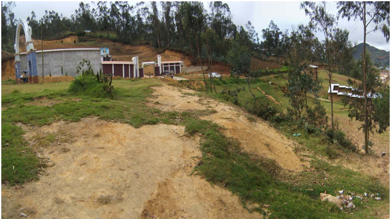
Foto 44 Sector de un camposanto particular, donde se distingue asentamiento del terreno; nótese los desniveles y el área deforestada para la construcción de este.
