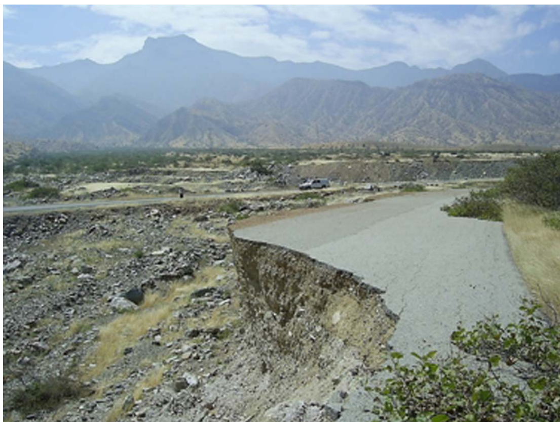
Foto 64 Quebrada Salitral; discurren huaicos de manera excepcional; viviendas se encuentran cerca del cauce (Tantarica, Cajamarca).
