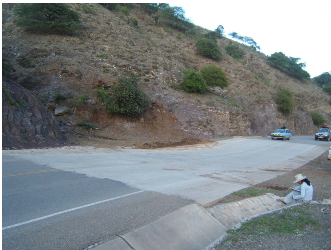
Foto 97 Sector entre Tuntupampa y Pampa Verde. Zona crítica con taludes de corte afectados por derrumbes, vuelcos y huaicos estacionales.
