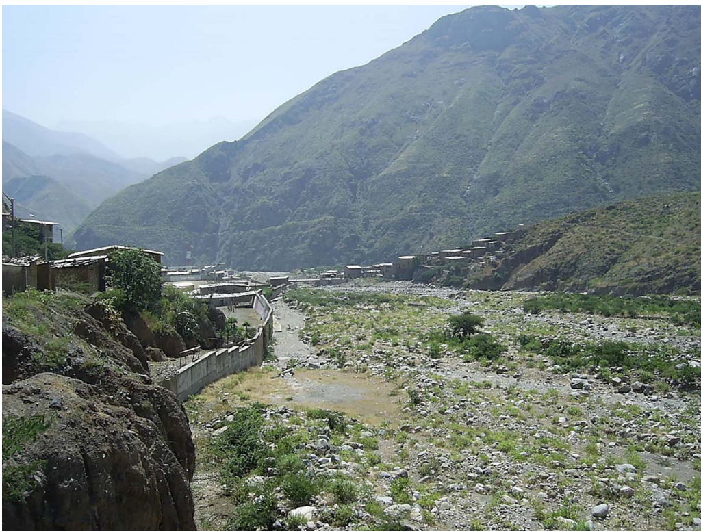
Muro ciclópeo, protección o defensa de ribera contra erosión fluvial e inundación y avenidas de huaicos en el valle del río Huertas (Chilite).
