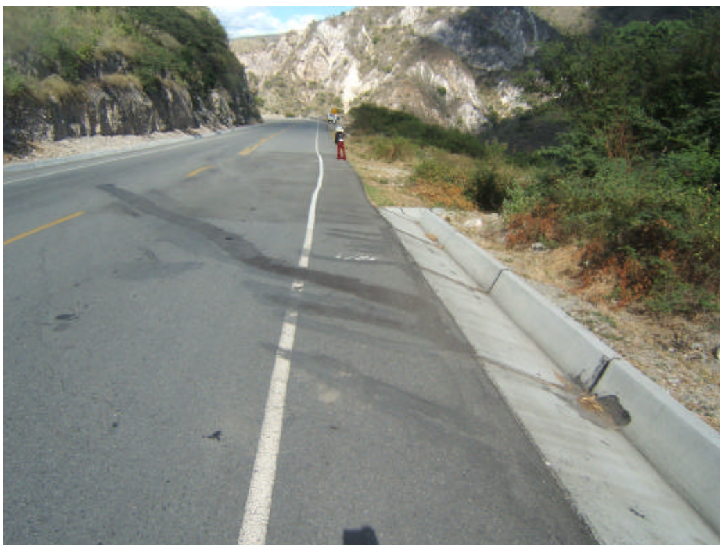
Foto 21 Asentamiento en la plataforma de carretera por proceso de deslizamiento activo.
