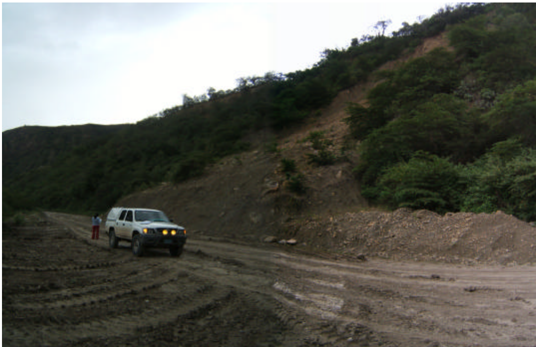
Foto 27 Deslizamiento que afecta un tramo de la carretera Jaén-San Ignacio.
