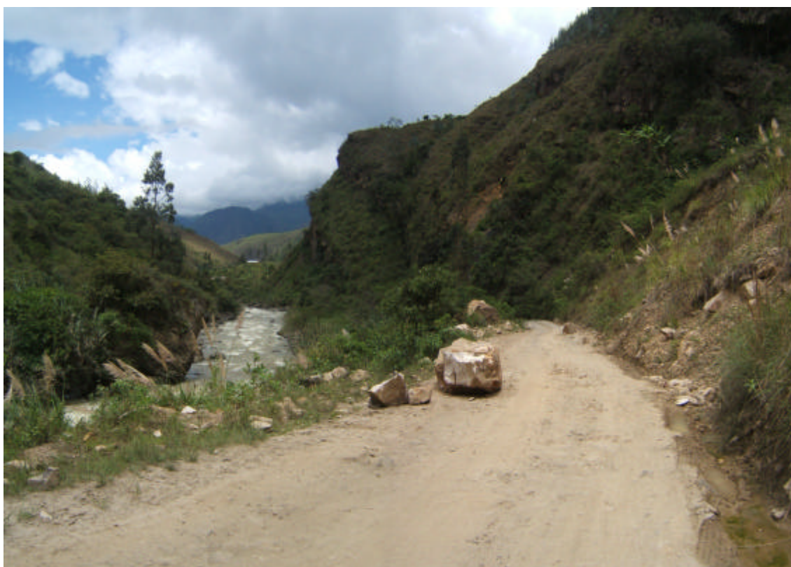
Foto 22 Tramo de carretera Bambamarca-Paccha susceptible a la ocurrencia de caída de rocas.
