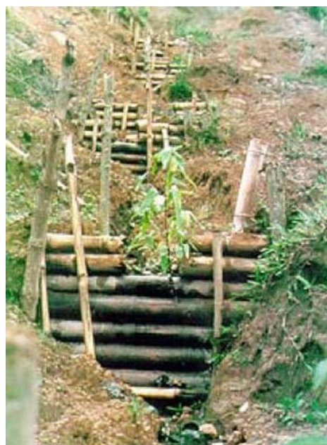
Evacuación de aguas superficiales y control de erosión en cárcavas, mediante trinchos escalonados
