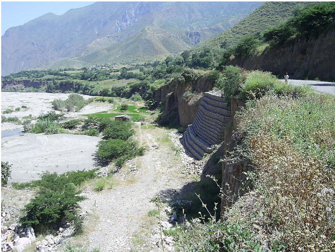
Ejemplo de construcción de muro de gabiones para protección de talud inferior de carretera a Cajamarca, valle del río Jequetepeque, susceptible a erosión fluvial.
