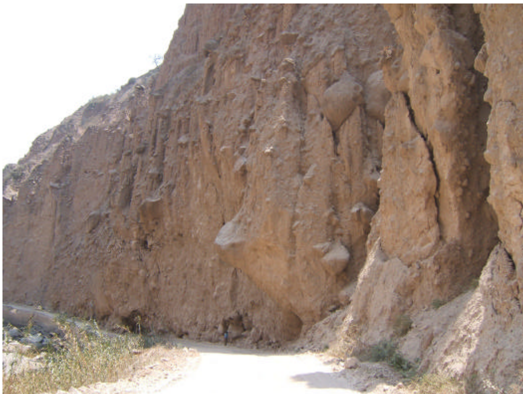
Foto 51 Derrumbes que afectan tramo de la carretera Chongoyape-Santa Cruz, en el sector Cumbil-Cirato (distritos de Llama, provincia de Chota).
