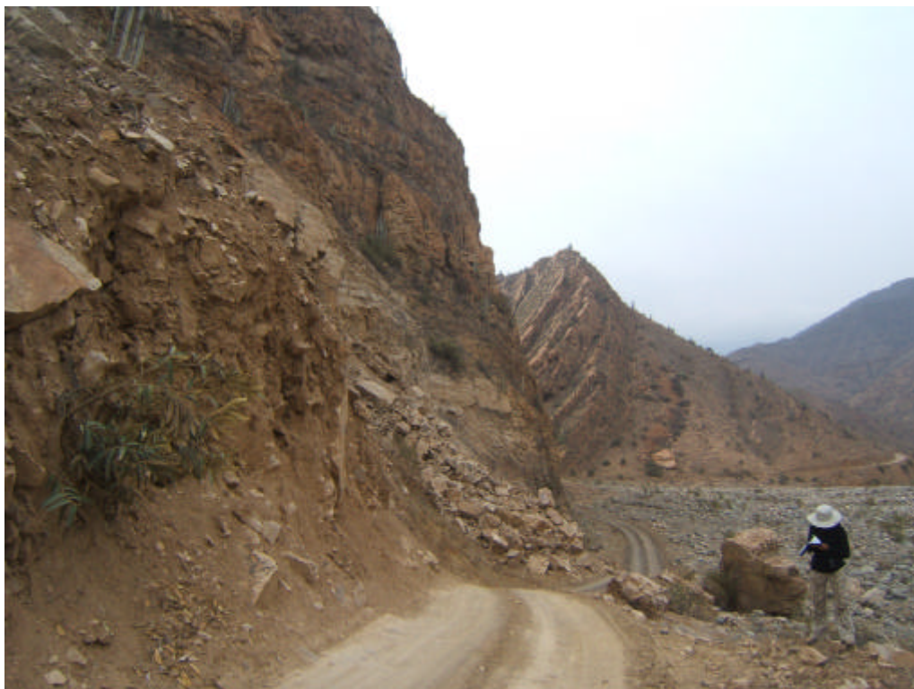
Foto 24 Caída de rocas y derrumbes en el tramo de carretera San Benito-Ascope, que involucra un substrato sedimentario de mala calidad.
