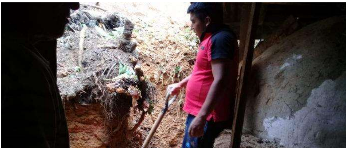
Fotografía 07. Vivienda afectada por flujos en el sector Algodonal.
