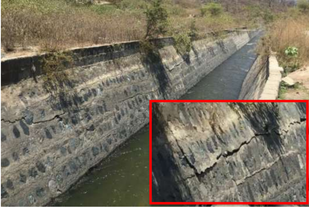
Figura 18. Grietas en los muros del Canal Quiroz.
