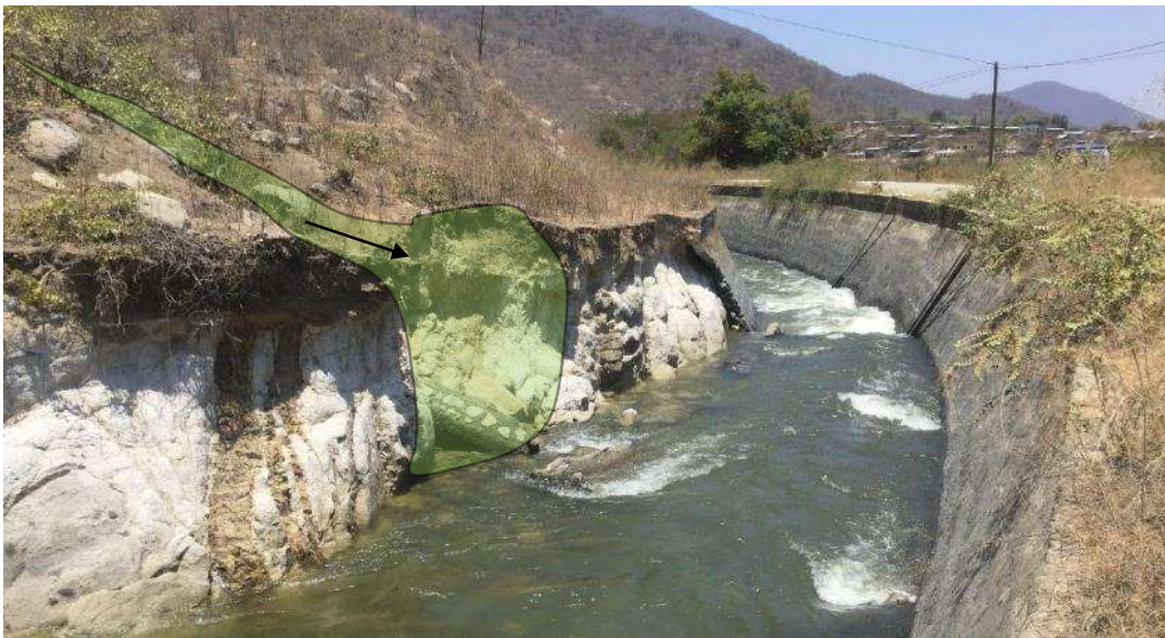
Figura 19. Canal afectado por cárcavas y erosión.
