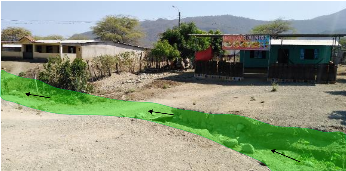
Figura 22. Viviendas del sector San Pedro afectadas por procesos de erosión cárcavas.
