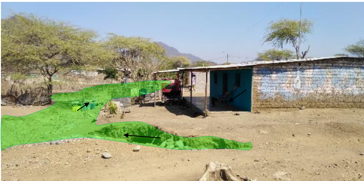
Figura 23. Las cárcavas tienen procesos retrogresivos que se aproximan a las viviendas.
