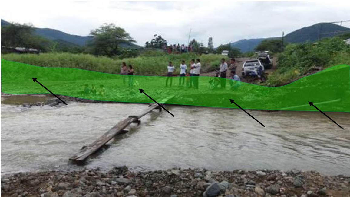
Figura 19. Erosión causada en la margen derecha de la quebrada El Higuieron.
