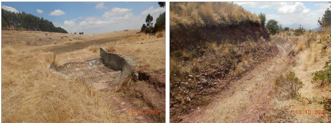
Figura 12. Canal de drenaje con revestimiento, realizado en la parte posterior de la margen izquierda de la quebrada Hatunhuayco, el cual mantiene estable los derrumbes en esa zona.
