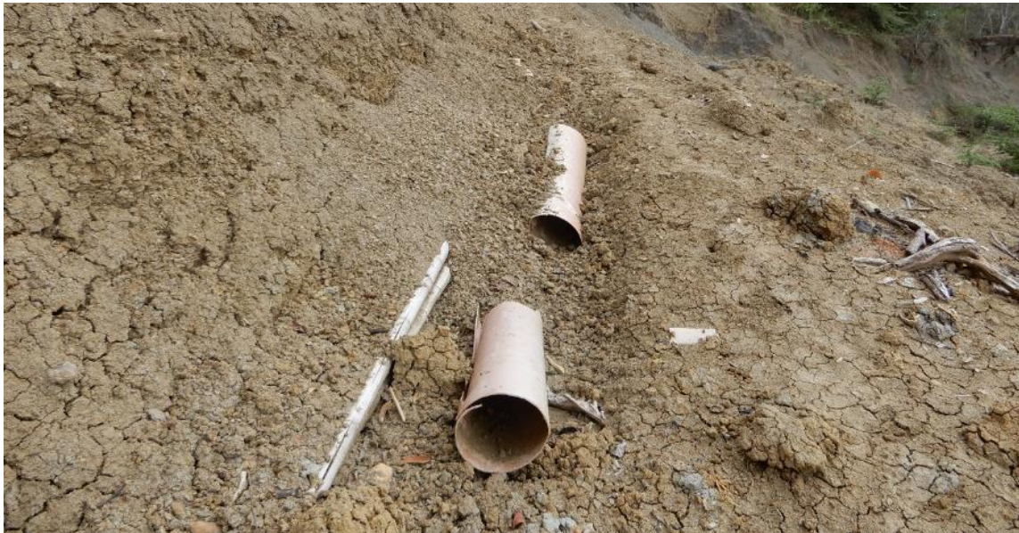
Fotografía 04. Tuberías de PVC destruidas por los movimientos de la ladera.
