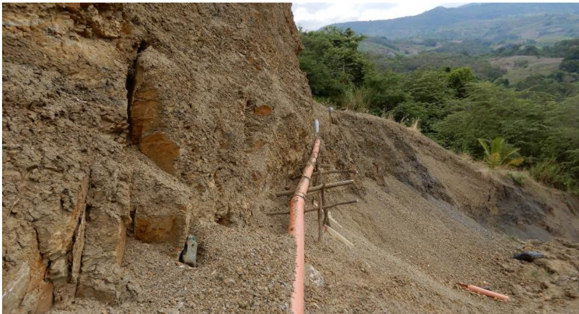
Fotografía 05. Tramo de 50 m de tubería con empalmes críticos.
