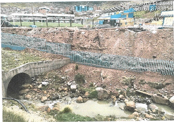
Fotografía 1: Deslizamiento del talud del río San Jose - Sector Huayllay
