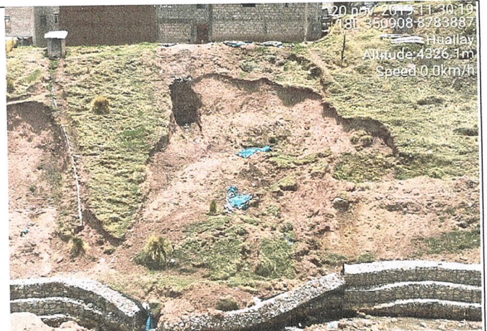
Fotografía 2: Deslizamiento del talud, de los muros tipo gavión en el río San Jose en el sector Huayllay.
