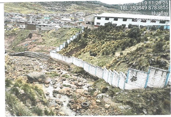
Fotografía 4: Colmatacion, exposicion a la socavacion y deslizamiento del talud del río San Jose en el sector Huayllay
