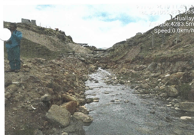
Fotografía 3: Peligro de deslizamiento ambas margenes del talud del río San Jose, en el sector Huayllay, que afectaría el PTAR de Huayllay.
