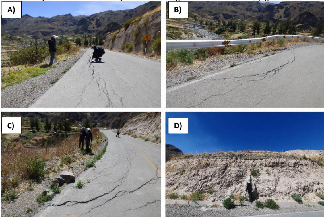
Figura 11. A, B y C), Muestran los distintos agrietamientos a lo largo de la carpeta asfáltica de la vía de acceso al centro poblado de Canocota, en D) muestras los distintos depósitos limo-arcillosos y los depósitos retrabajados al tope de la secuencia, sobre el cual está emplazado la vía.
