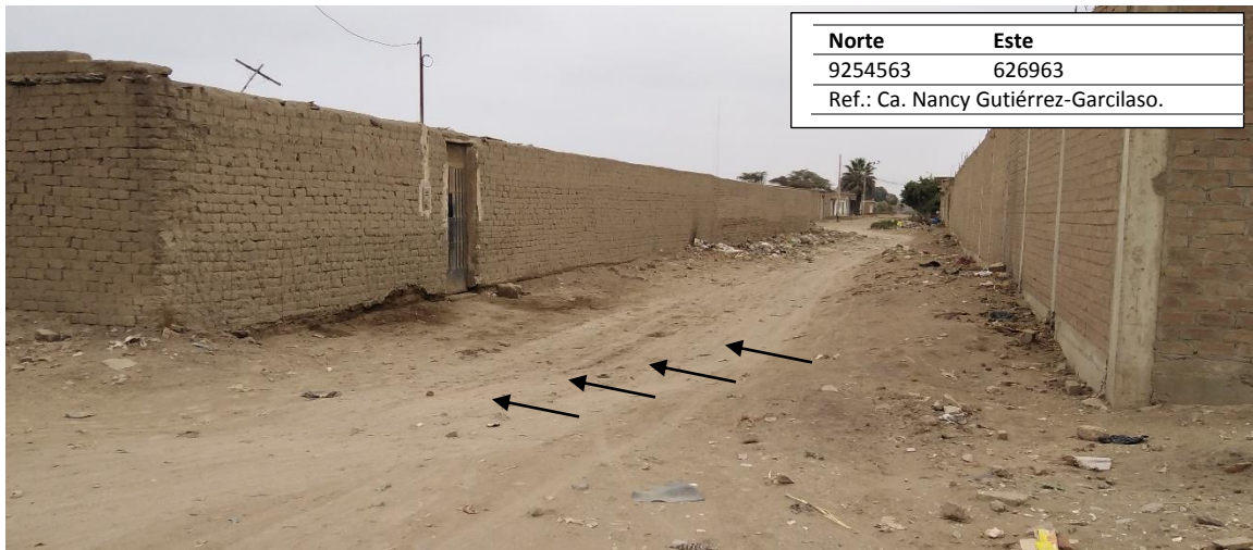
Figura 24. Vivienda afectadas por la escorrentía.
