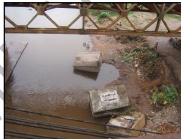
Erosión fluvial en la margen derecha del río Aguaytía.
