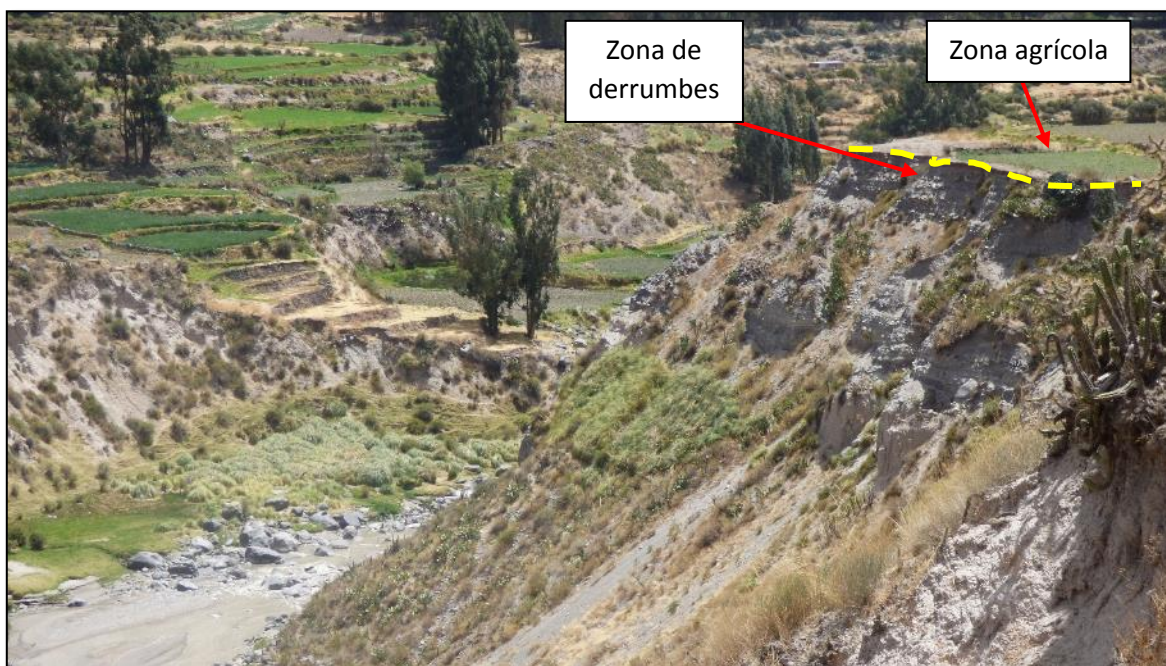
Figura 41. Zona de derrumbes en el sector Linde.
