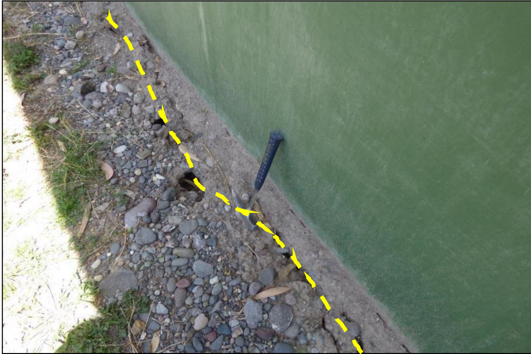
Figura 30. Agrietamientos en la base del pozo séptico en el sector El Petar.
