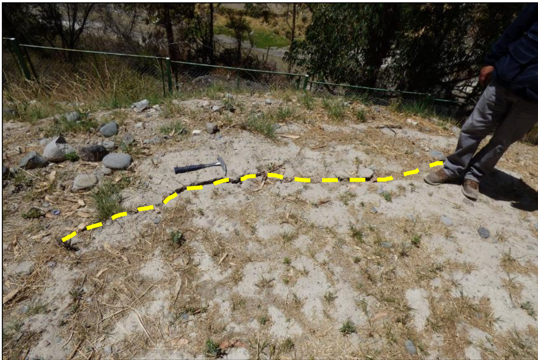
Figura 31. Agrietamientos en la plataforma donde está ubicado el pozo séptico en el sector El Petar, (coordenadas UTM E: 211357, N: 8267829).
