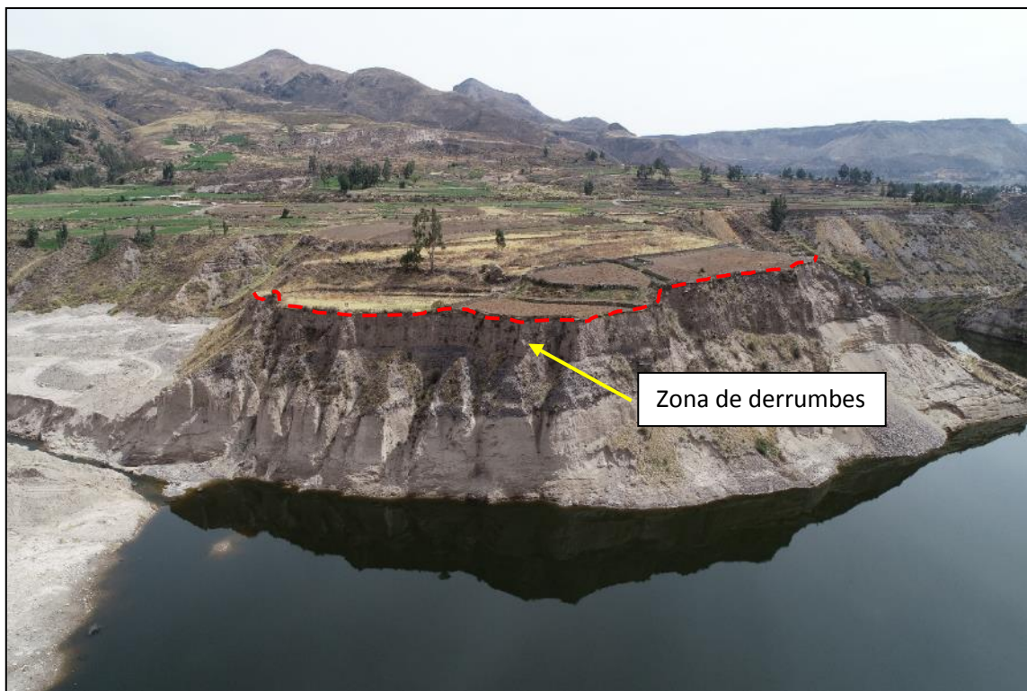
Figura 25. Zona de derrumbes en el sector Chacapi.
