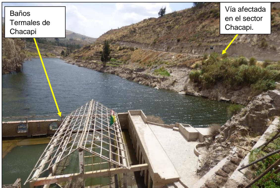
Figura 18. Muestra los daños en los Baños Termales de Chacapi, (coordenadas UTM E: 213722, N: 8267387).
