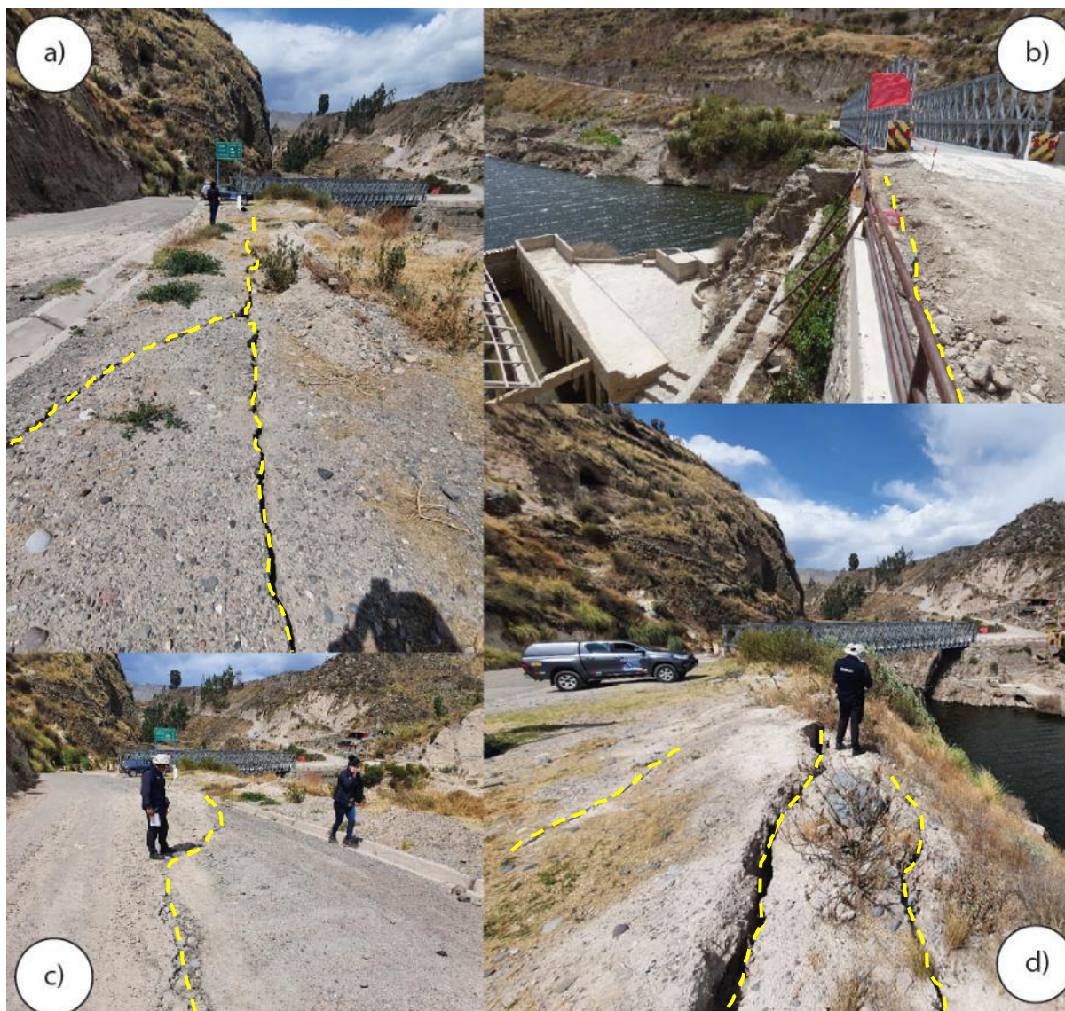
Figura 26. En a, c y d) se aprecian los agrietamientos que afectó aproximadamente 80 m de la vía, en el sector Chacapi, en b) se aprecian los agrietamientos en el muro cerca de la entrada a los baños termales de Chacapi. Coordenadas UTM a) E: 213647, N: 8267371, b) E: 213725, N: 8267384, c) E: 213641, N: 8267388 y d) E: 213667, N: 8267402.
