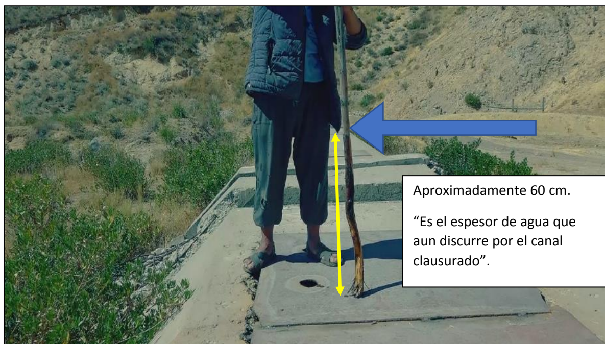
Figura 15. Canal Majes Sigwas, presencia de agua, en tramos clausurados de canal.
