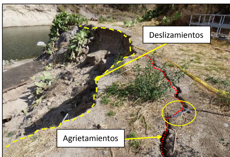
Figura 22. Deslizamiento en la parte baja del Hotel Colca Lodge, (coordenadas UTM E: 213934, N: 8267777).
