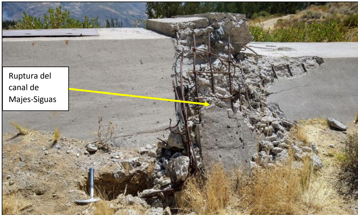
Figura 3. Ruptura del canal Majes Siguas, que cruza el sector de Collpane.
