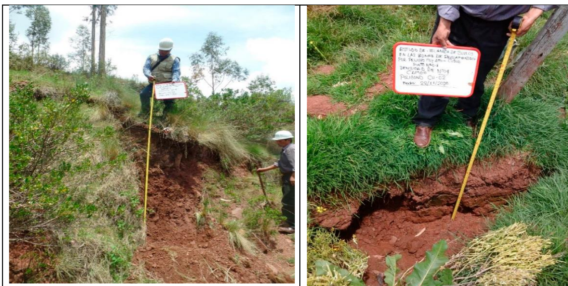
Fotografía: vista del corte del talud donde se observa el basamento rocoso conformado por areniscas cuarzo-feldespáticas y lutitas, pertenecientes a la formación Kayra, en conjunto se encuentran altamente intemperizados y alterado. Coordenada UTM 175274.39 E, 8505206.85 N.
