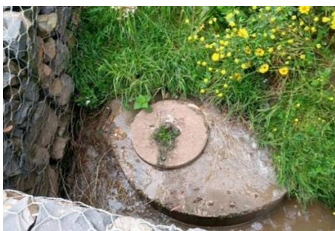
Fotografía: Buzón colapsado cuyas aguas se vierte a la quebrada.
