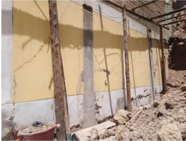
Foto 1. Agrietamientos en pared de casa que contuvo el deslizamiento.
