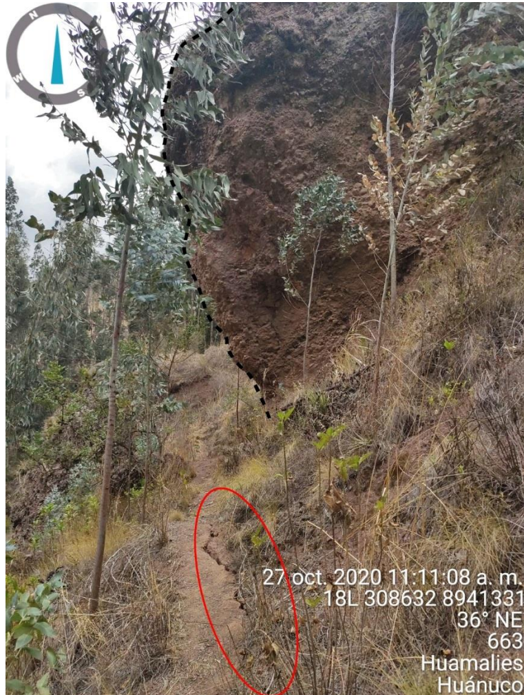
Figura 9. Agrietamientos proyectándose a protuberancia rocosa de conglomerados (promontorio).
