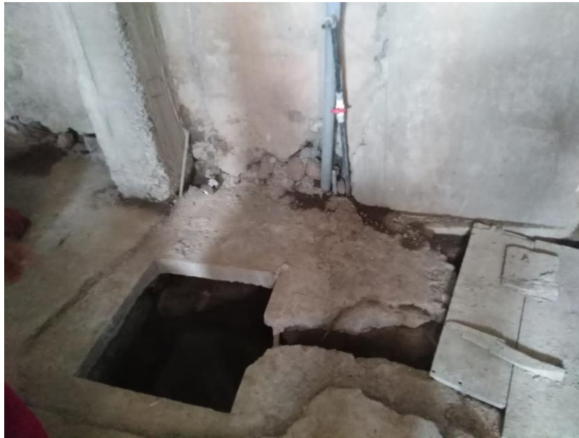
Foto 2. Zanja al interior de vivienda con presencia continua de agua.
