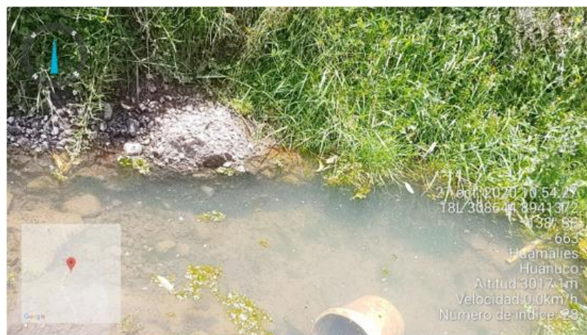
Figura 7. Acumulación de agua en trayecto de canal sin revestimiento.
