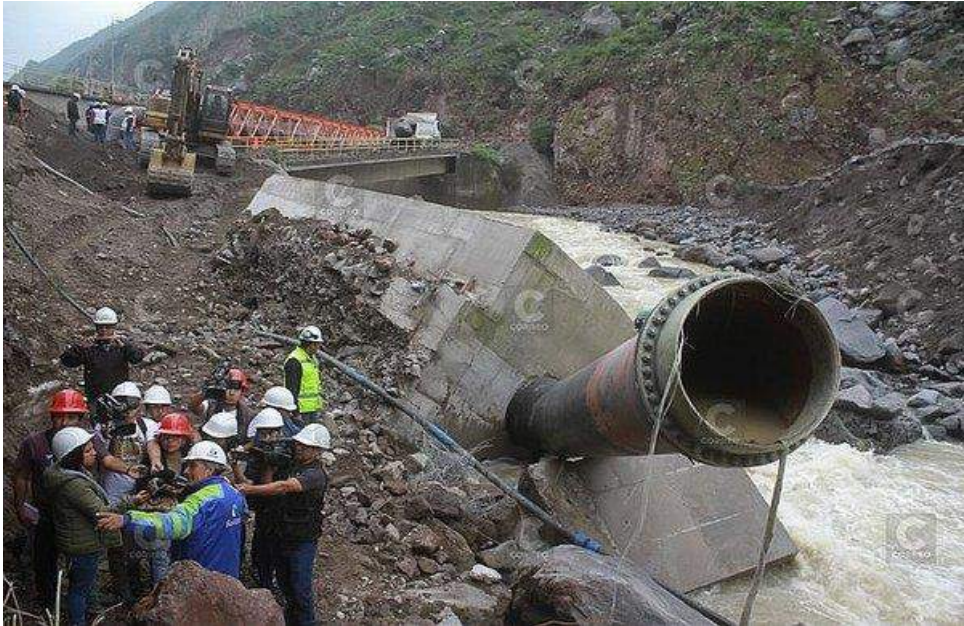
Figura 14.- Vista de la planta de captación de agua potable de la Tomilla II de SEDAPAR afectada por un lahar en febrero de 2017 (Foto: Diario Correo)
