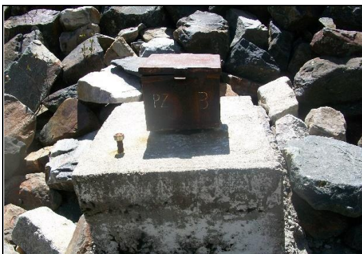
Fotografía N° 19.- Cabezal del piezómetro tipo Casagrande que se ubica en el talud aguas abajo de la presa.
