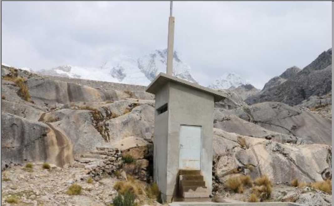
Fotografía N° 06: Vista de la caseta de válvulas de compuerta de regulación.
