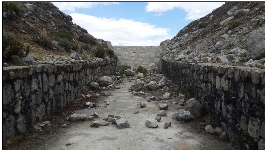
Fotografía N.° 08: Dique de seguridad: se visualiza caída de rocas – talud aguas arriba
