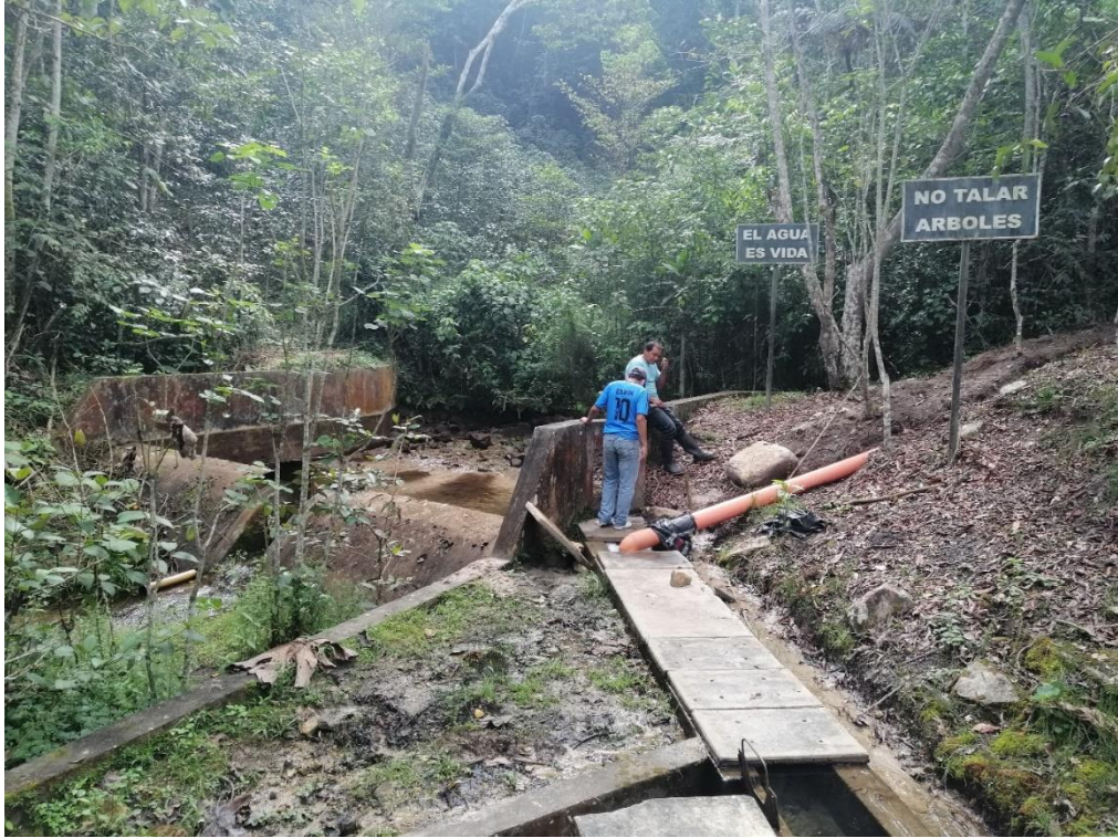
Fotografía 11. Captación el sistema de agua potable. Se ubica a 20 m aguas debajo de la confluencia de las quebradas Tioyacu Margen Derecha y Tioyacu Margen izquierda.
