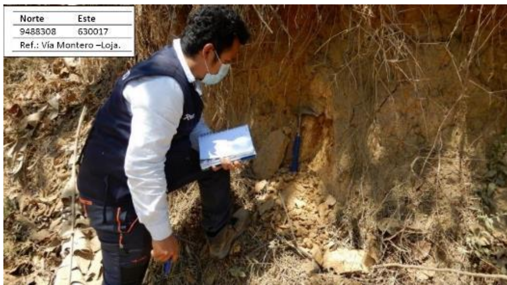
Figura 31. Margas muy fracturadas, mediante prueba de martillo se fracturan con facilidad.
