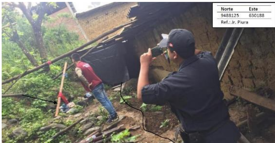
Figura 37. Vivienda afectada por deslizamientos y flujos.
