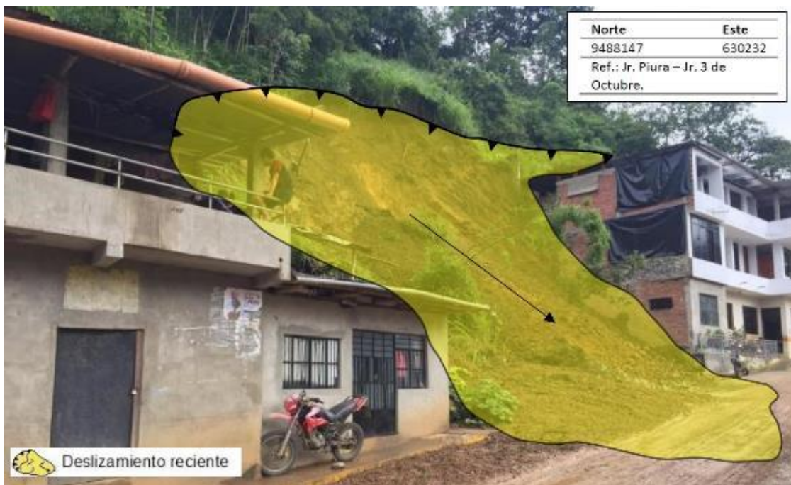
Figura 17. Deslizamiento DR-01 que afecta a 12 viviendas y que llega hasta el Jr. Piura.
