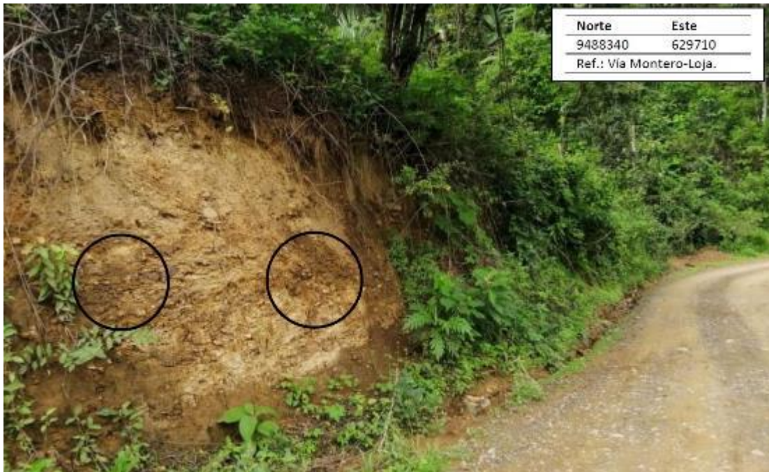
Figura 32. Presencia de humedad alta en afloramientos de calizas y margas.
