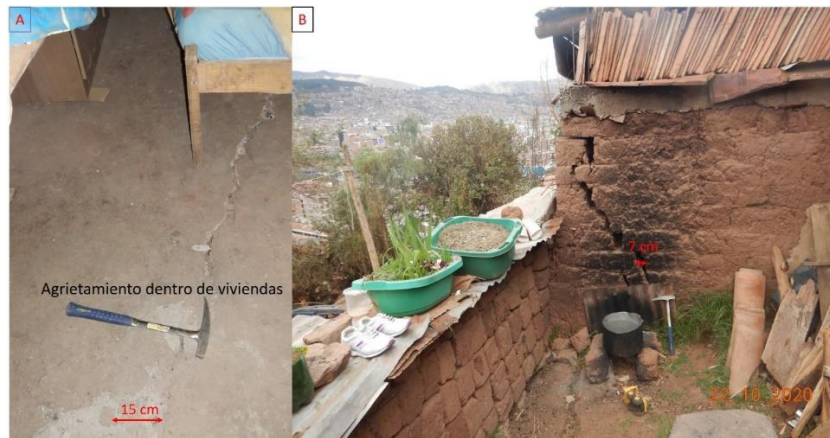
Figura 13. Vista de la figura B tomada en coordenadas UTM (GWS184-Zona 19s) E 178138; N 8501681. Se aprecia presencia de grietas retrogresivas ubicadas fuera del deslizamiento, que afectan pisos y paredes de las viviendas del sector.
