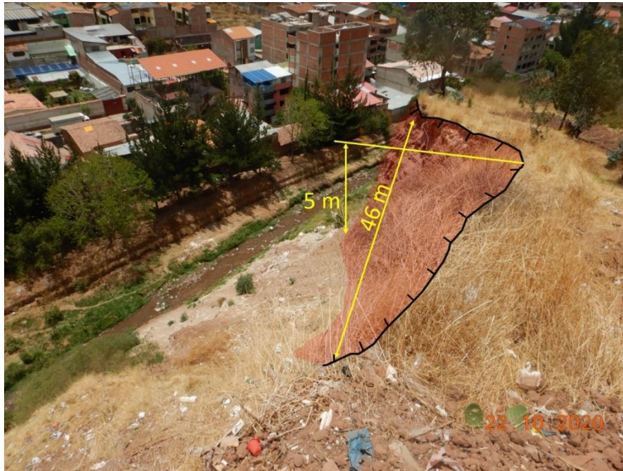
Figura 15. Vista tomada en coordenadas UTM (GWS184-Zona 19s) E 178251; N 8501739. Derrumbe de detritos del sector noreste del A.H. Arahuay, se aprecia las medidas del derrumbe.
