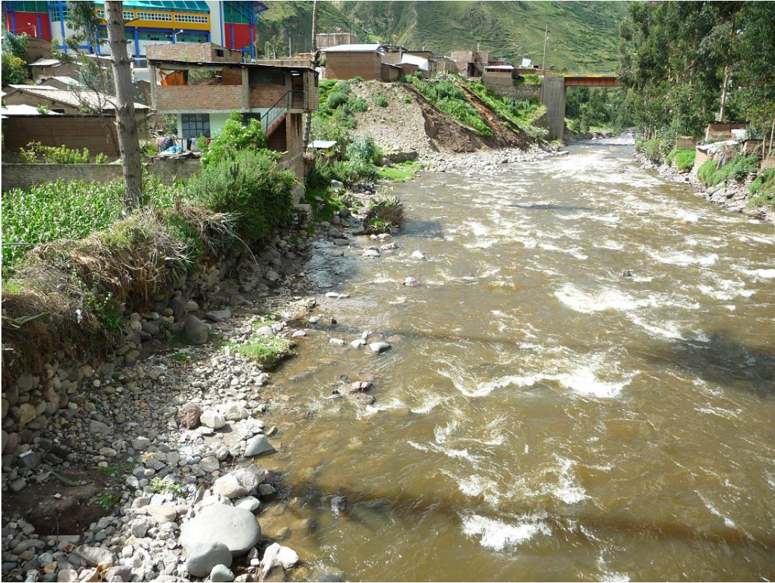
Foto N° 9. Margen izquierda del río Sicra (paralela al Jirón Ocoña) susceptible a inundaciones y erosión fluvial.
