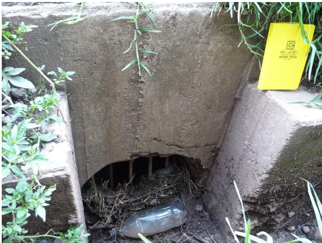
Foto N° 6. Comparación del tamaño del cuaderno (20cm) con el canal para drenar las aguas flujos de las cárcavas. Intersección del Jirón 6 de agosto y la vía de Evitamiento.
