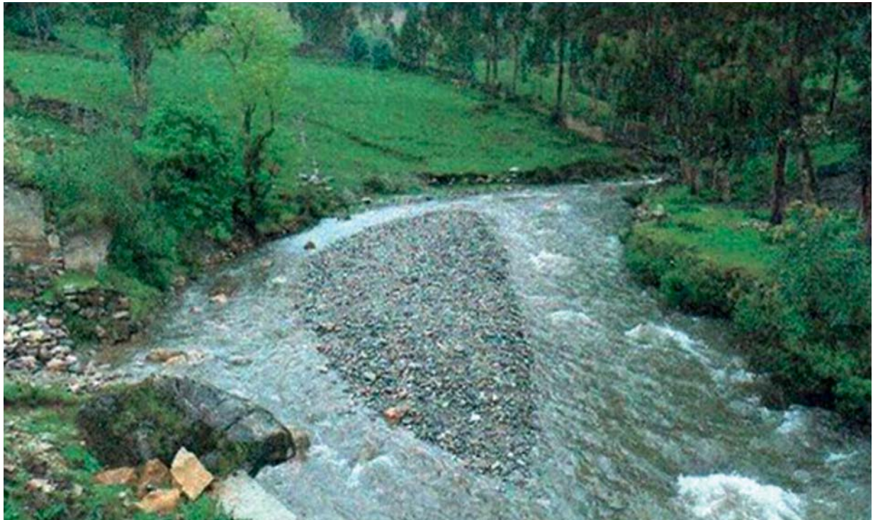
Sector puente Huancapucro, el cauce del río se encuentra colmatado de sedimento y también ocurre erosión fluvial en la margen derecha del río Ticlacayán
