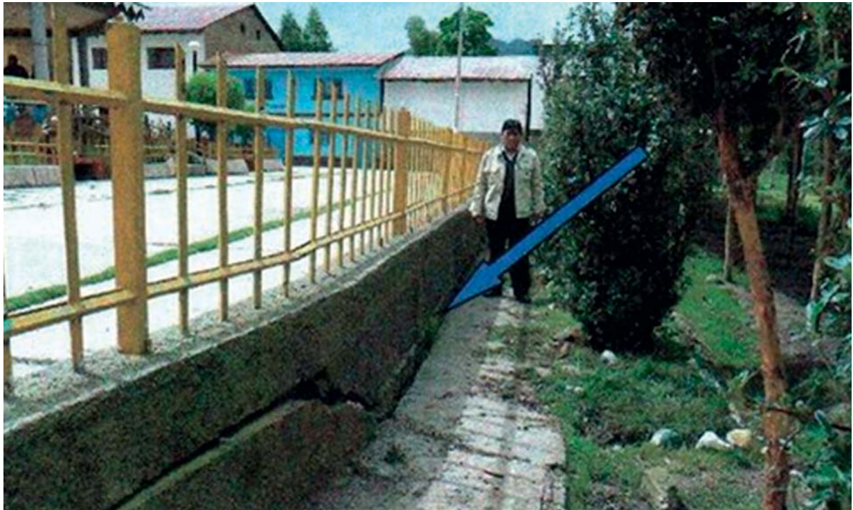
Agrietamiento de piso del muro de rejas que rodea la plaza de armas de Ticlacayán
