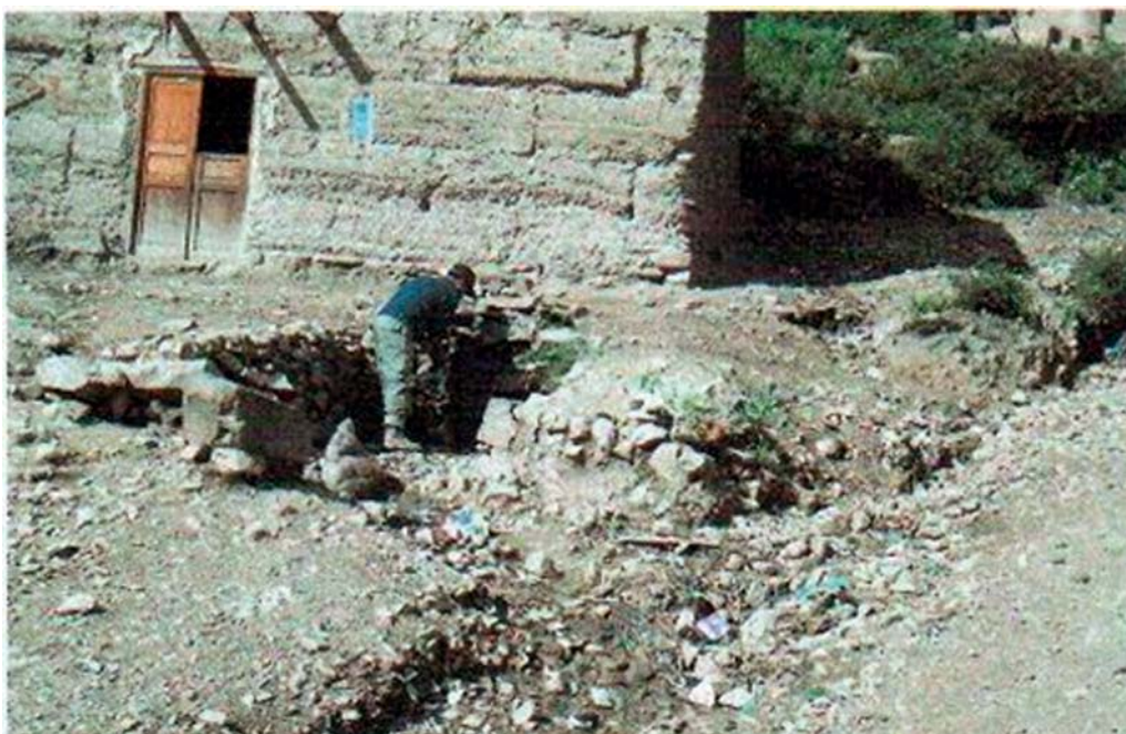
Unos de los Manantiales que aflora en la parte baja del Pueblo Obras de drenaje pluvial
