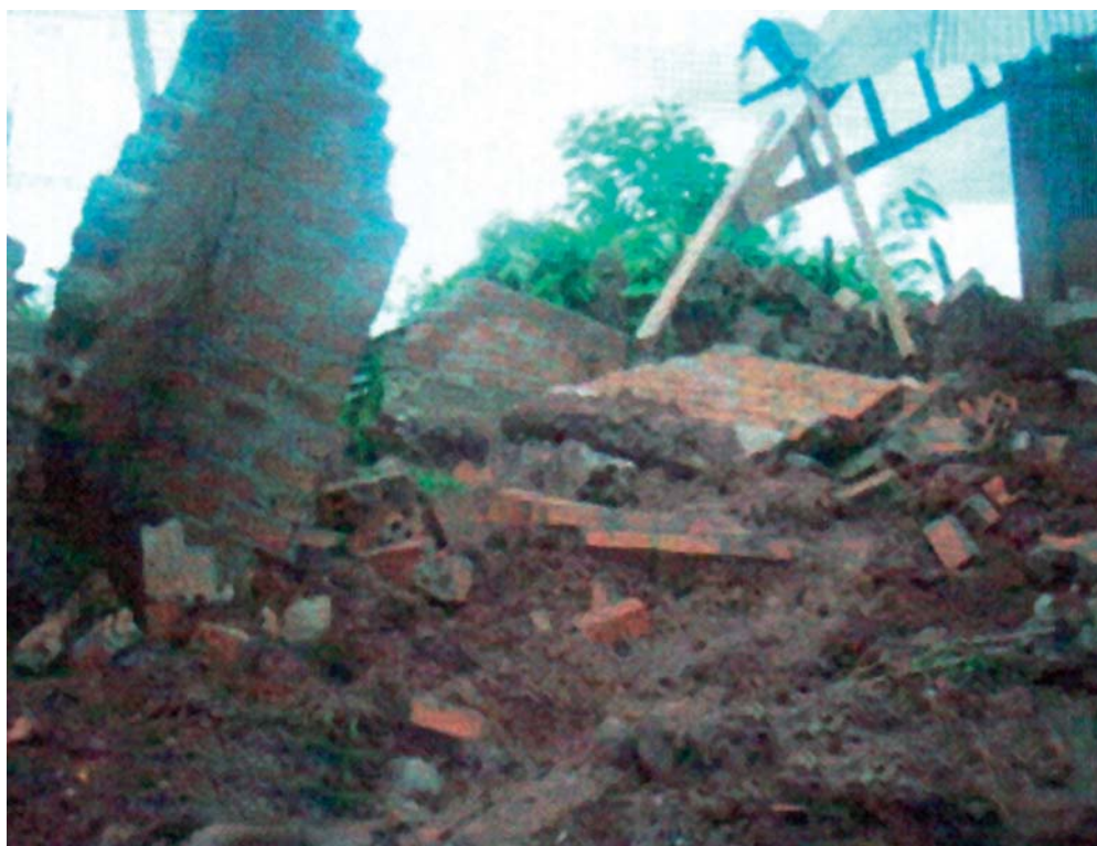
Foto 6: Infraestructura que ha colapsado por el deslizamiento-flujo
