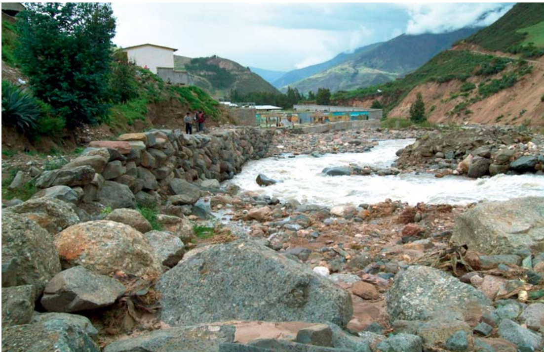
Defensas ribereñas que deben ser reforzadas
