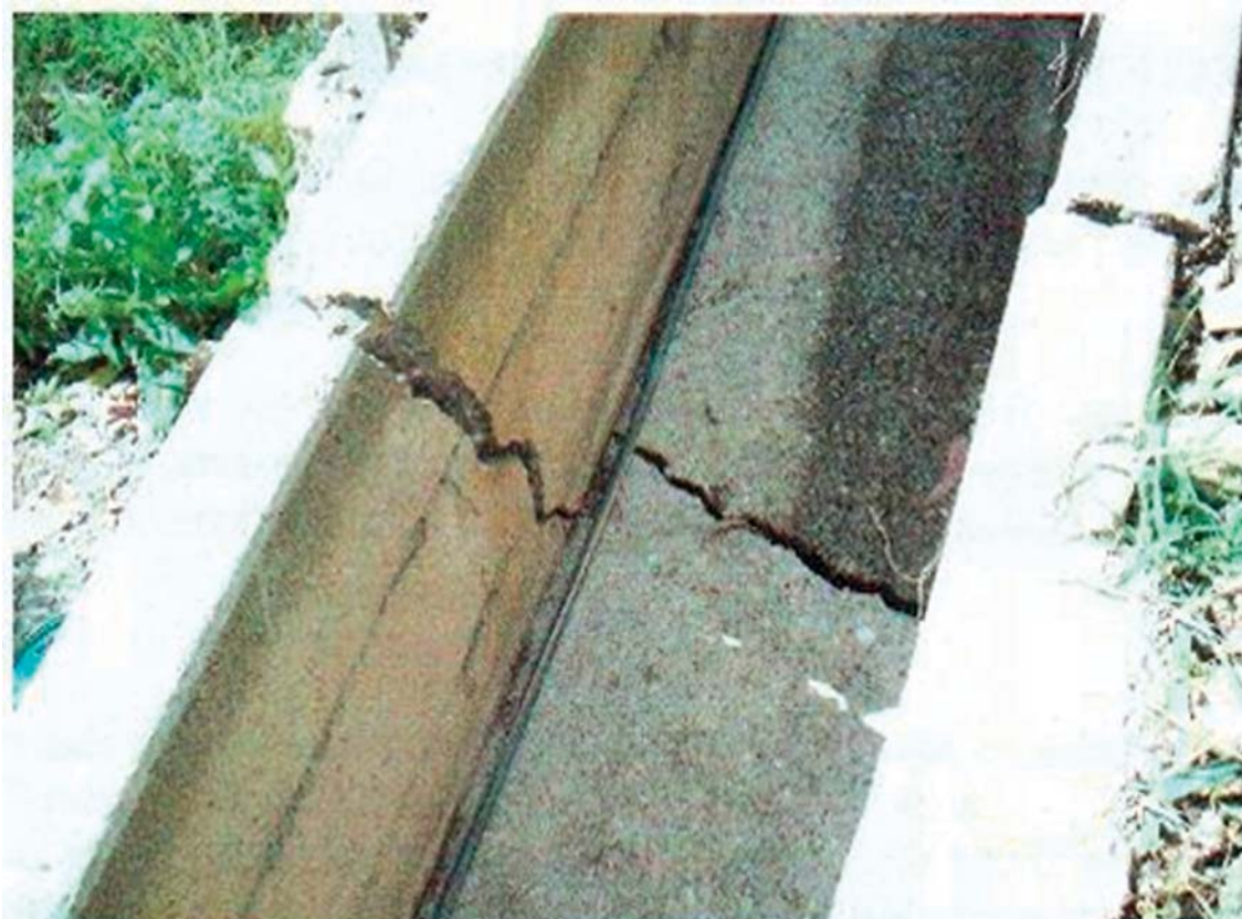
Canal de drenaje con fuertes fisuras
