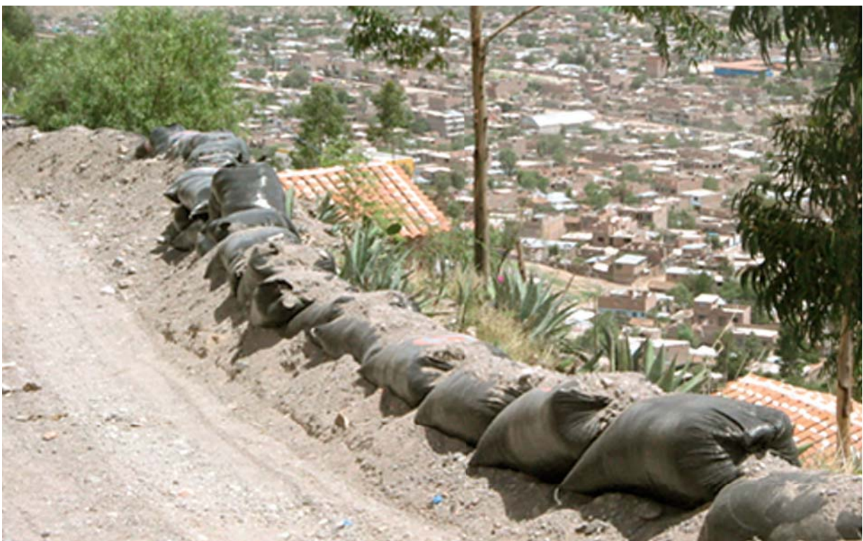
Uso de sacos terreros. Viviendas afectadas en el cerro Picota
