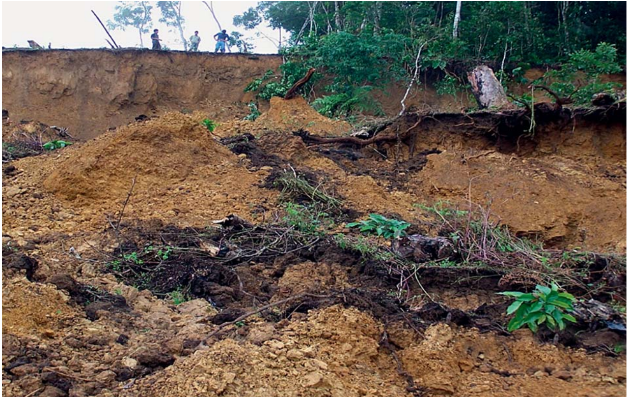
Deslizamiento a consecuencia de fuertes precipitaciones pluviales ocurridas en el Departamento de San Martín, enero 2009.
