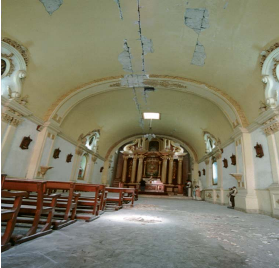
Daños en la bóveda, iglesia de San Lázaro – Arequipa, terremoto 23 de junio 2001
