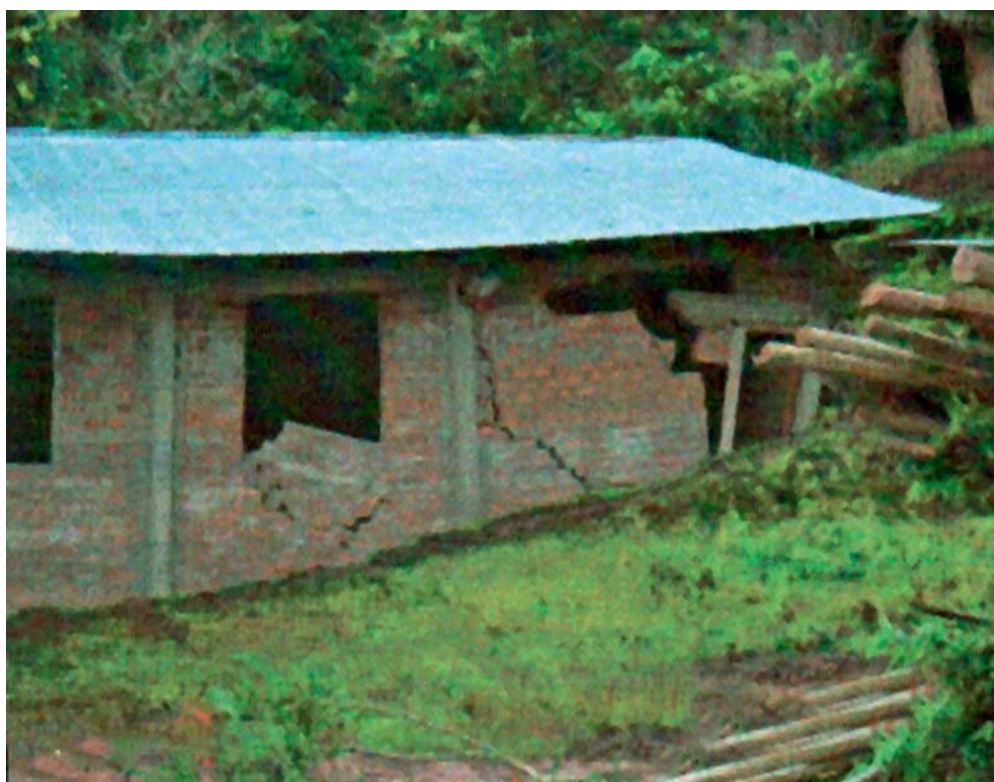
Foto 5: Vivienda que ha colapsado por el deslizamiento-flujo
