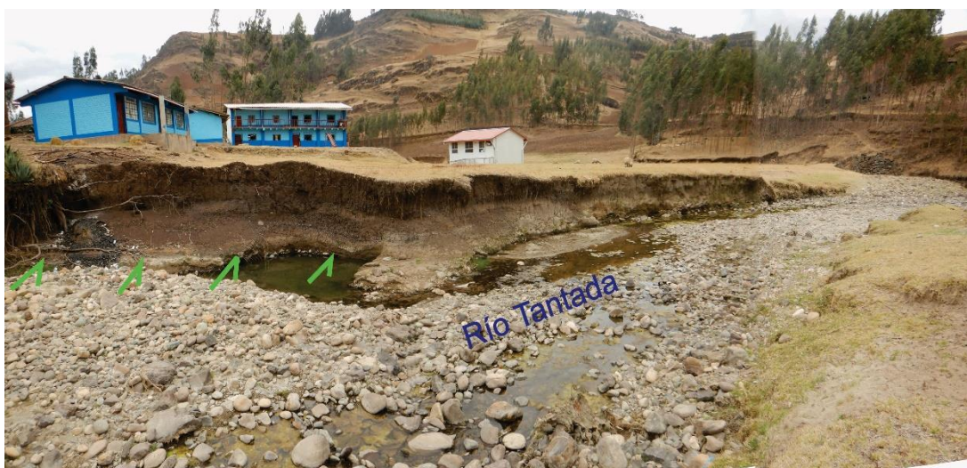
Figura 19. Se observa erosión fluvial en la margen izquierda próximo a las instalaciones educativas del caserío de Las Playas.
