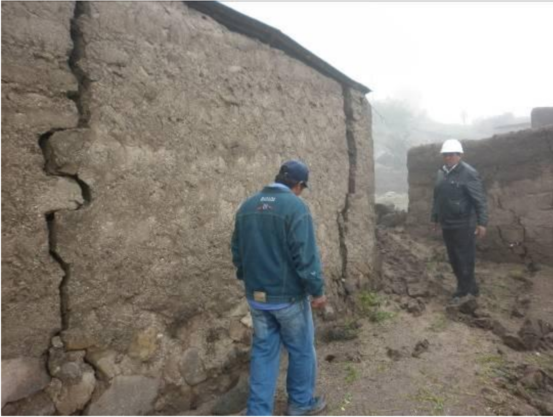
Grietas pronunciadas en las viviendas de Amata
