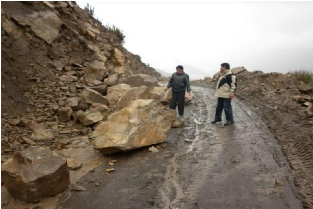
Deslizamiento de rocas, a consecuencia de las permanentes lluvias ocurridas en la zona, interrumpiendo las vías de comunicación.
