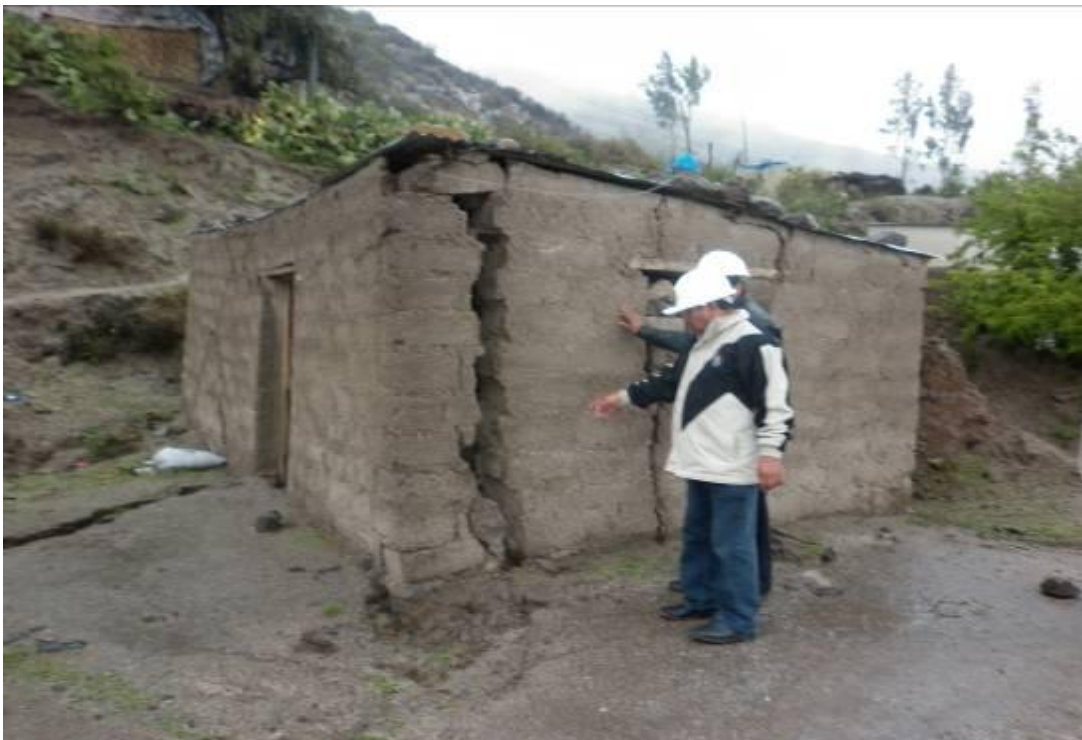
Las viviendas con evidencia de grietas en los muros, a punto de colapsar, encontrándose la población en alto riesgo.
