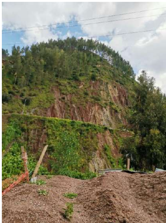
FOTOGRAFÍA 18: ESCARPADAS, SE PRESENTA ESCARPE DE DESLIZAMIENTOS ACTIVOS.
