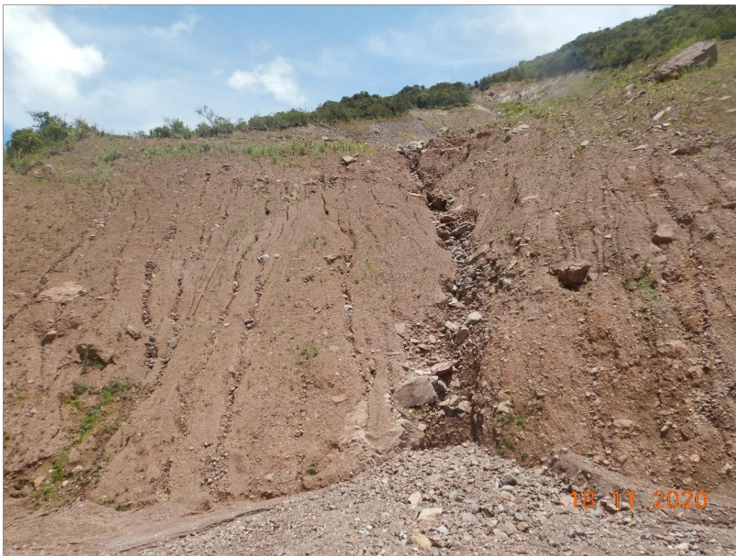
Fotografía 5. Cárcava, con un ancho de 3 m y una profundidad de 0.6 m, en dicho canal se observó bloques de hasta 0.5 m de diámetro. Hacia la derecha de la cárcava la escorrentía superficial erosionó las paredes de las banquetas, cuyos surcos presentan un ancho de 0.10 m en promedio. Coordenadas UTM (WGS 84): 722087 E, 8548421 N a 3242 m s.n.m.
