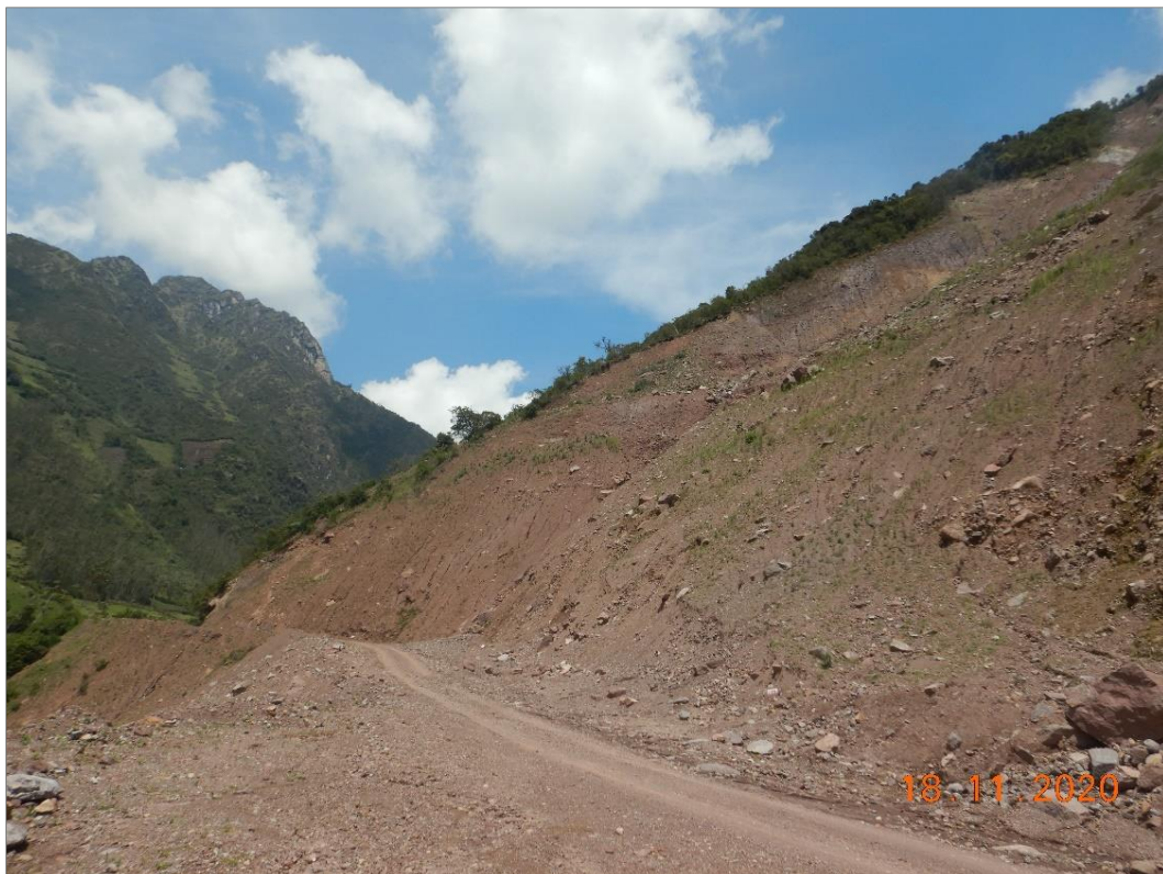
Fotografía 4. Tramo carretero Pucyura - Curcuchaca afectado por la reactivación del deslizamiento de Curcuchaca, con coordenadas (WGS 84): 817144 E, 8498265 N a 3611 m s.n.m.
