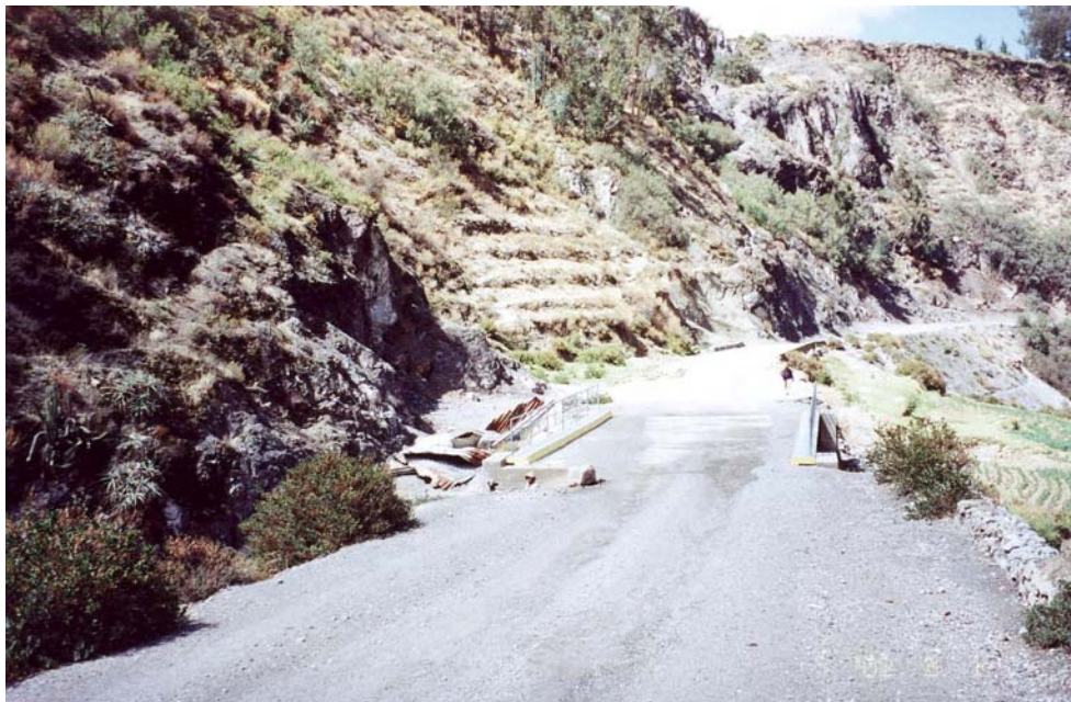
Foto 14.- Puente en el tramo de la carretera Tarata-Ticaco, a unos 800 metros del poblado de Tarata. En el lado izquierdo del puente se puede apreciar las consecuencias de los temporales de lluvias en la zona. El temporal de lluvias que se viene presentando, en este primer trimestre del año 2002, podrían concluir con el colapso total de la infraestructura ingenieril.
