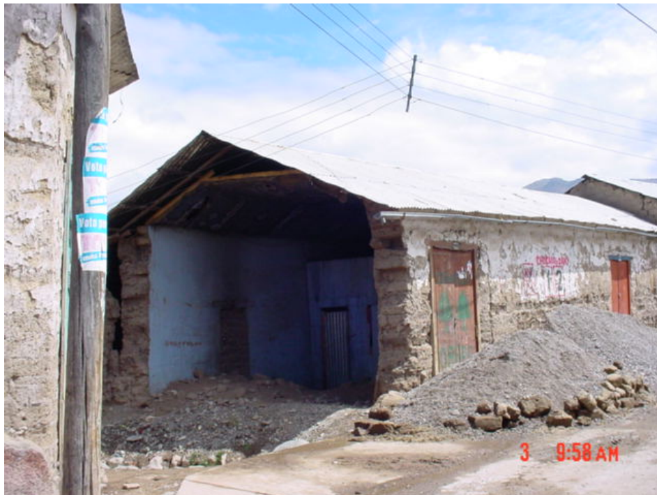
Foto 16.- Vista a una vivienda construida con adobes en el cercado de Tarata, la cual fue afectada por el sismo del 23 de junio del 2001.
