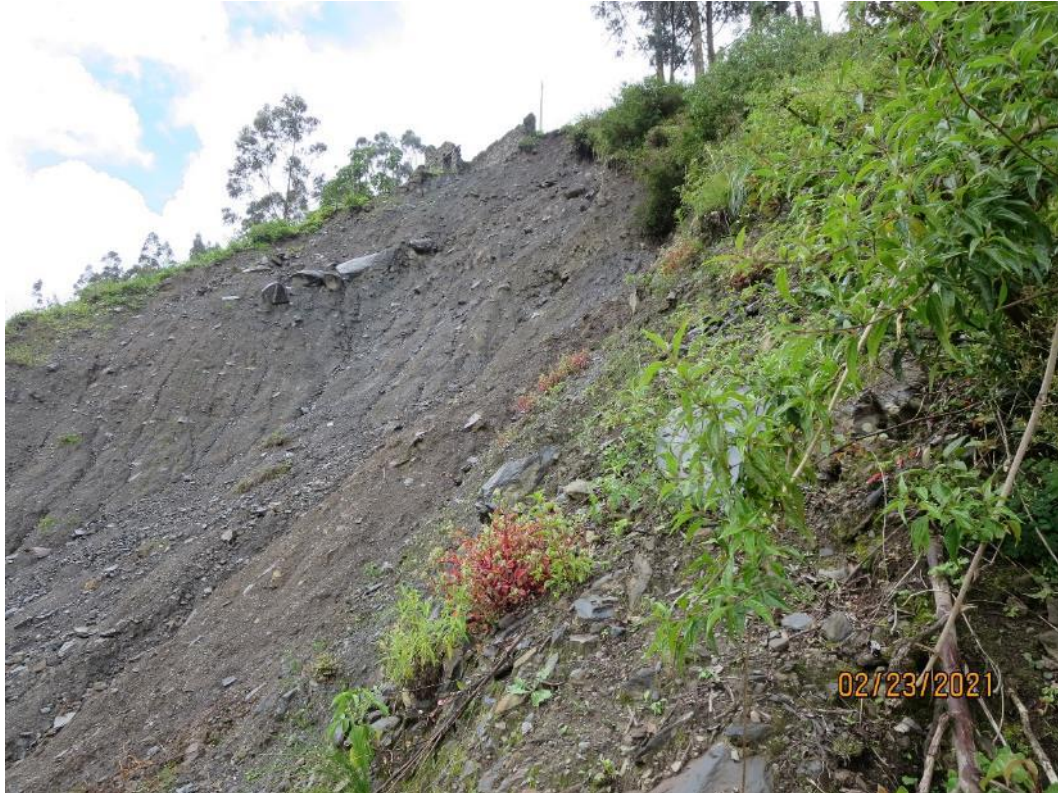
Fotografía 3. Depósito coluvial, fotografía tomada con vista hacia el escarpe del derrumbe, ubicado en el sector Llamani.
