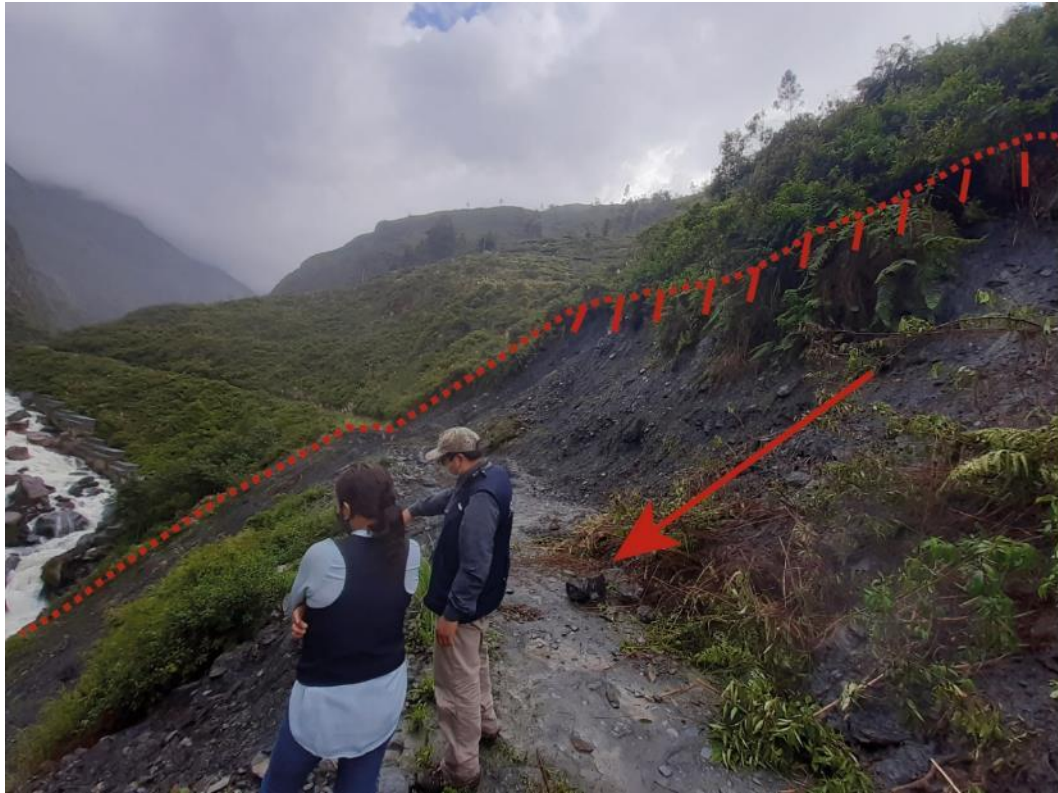
Figura 17. Imagen tomada con dirección noreste, se observa el derrumbe que afecta 45m de carretera afirmada, ubicado en el sector Pampallamani.
