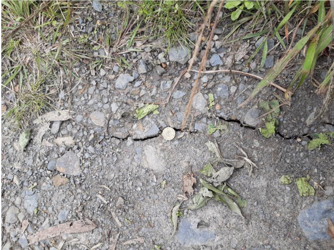
Fotografía 5. Grietas ubicadas sobre la vía que se ubica aproximadamente a 15m sobre el escarpe del derrumbe en el sector Llamani.
