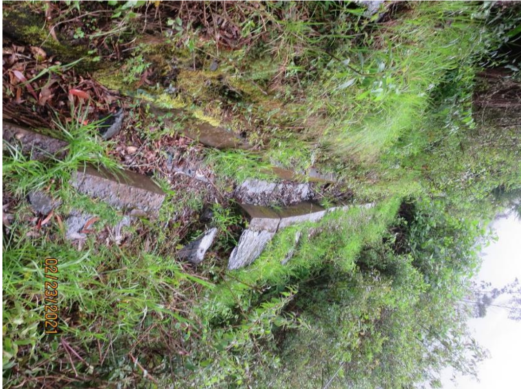
Fotografía 6. Canal de riego en mal, se encuentra aproximadamente a 6m sobre el escarpe del derrumbe, presenta grietas por donde infiltra el agua que discurre por el lugar. Esto provoca la saturación del terreno, ubicado en el sector Llamani.
