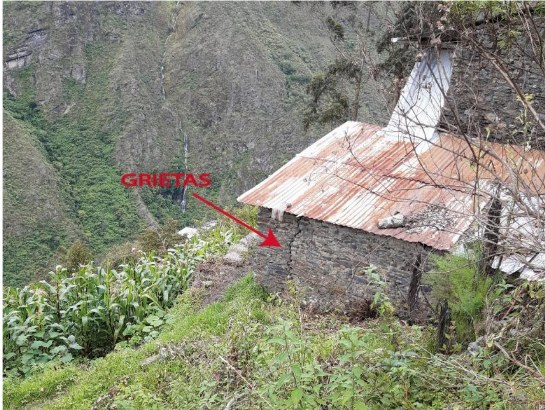
Figura 14. Se observa grietas en la pared de una vivienda ubicada a 30m del flanco izquierdo del derrumbe en el sector Llamani.
