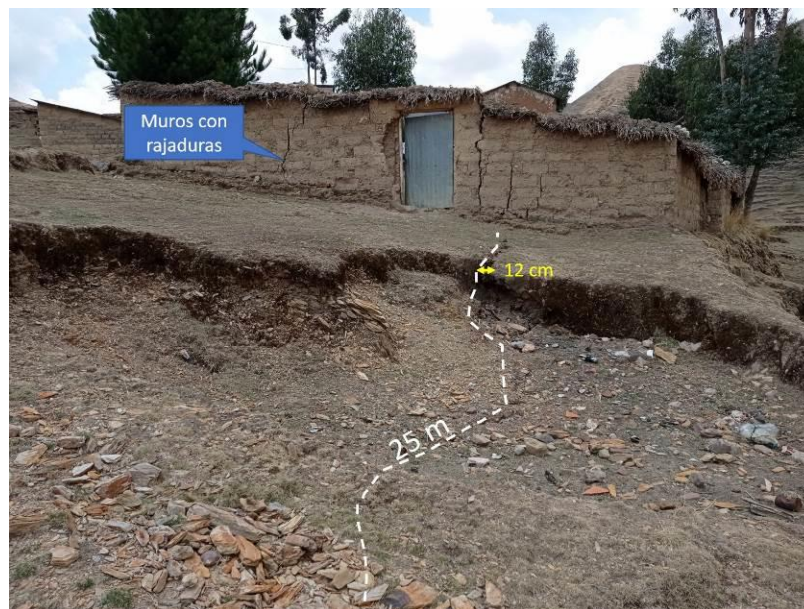
Figura 12. Vista tomada en coordenadas UTM E 238216; N 8466203. En la vista se aprecia las grietas que aparecieron recientemente en la parte alta del sector.
