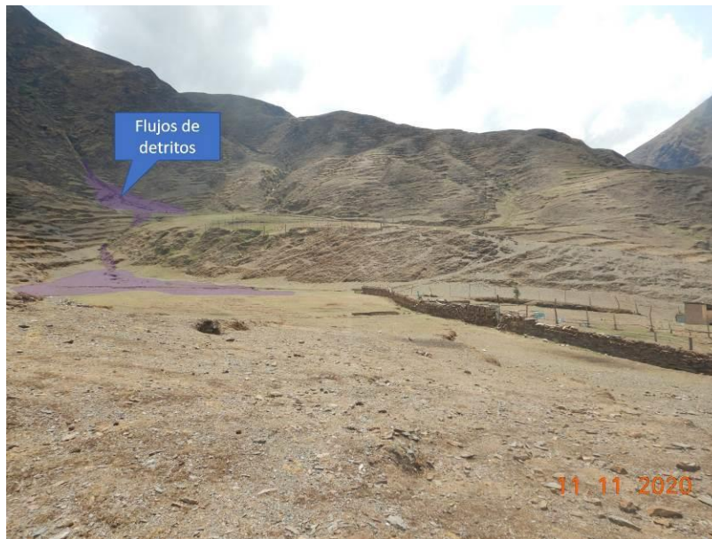
Figura 10. Vista tomada en coordenadas UTM E 239044; N 8466074. En la vista se aprecia los flujos de detritos que se desplazan en medio de los drenes.
