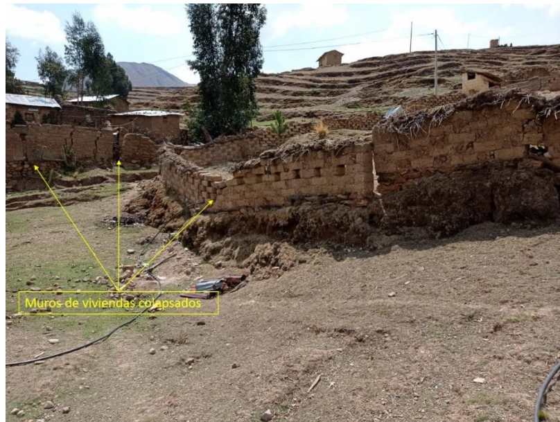
Figura 16. Vista tomada en coordenadas UTM E 238297; N 8466135. Se aprecian grietas que dejan muros colapsados de las viviendas.
