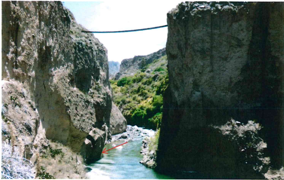
Foto 17. Puente colgante peatonal "Chayme" construido sobre depósitos de avalancha. Con flecha roja se señala la erosión fluvial del pie de talud.
