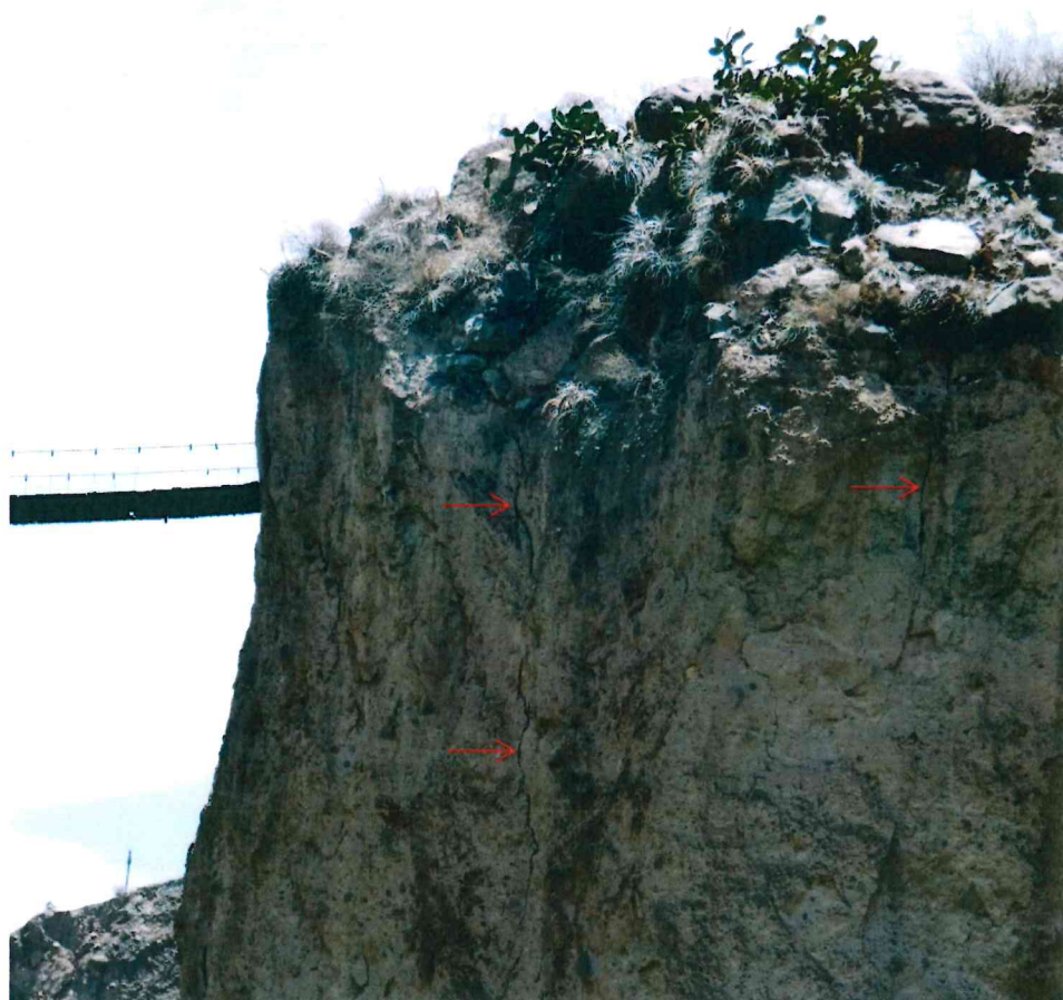
Foto 18. Con flechas rojas se señala las pequeñas fisuras en el talud que soporta al puente peatonal "Chayme". Margen izquierdo del río Cotahuasi.
