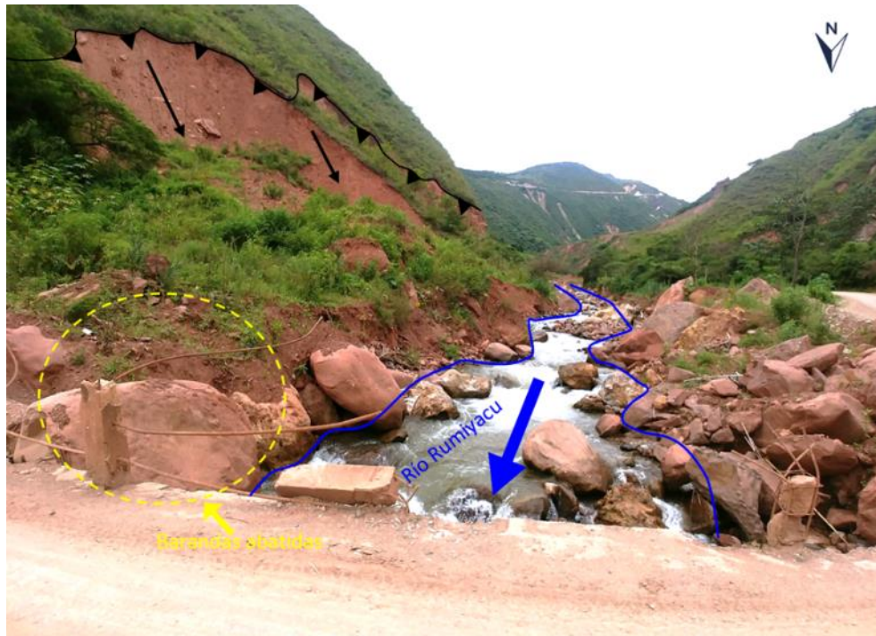
Figura 11. Vista de la zona afectada por embalse temporal y puente deteriorado, motivo por el cual en la carretera no hubo pase por 22 días.
