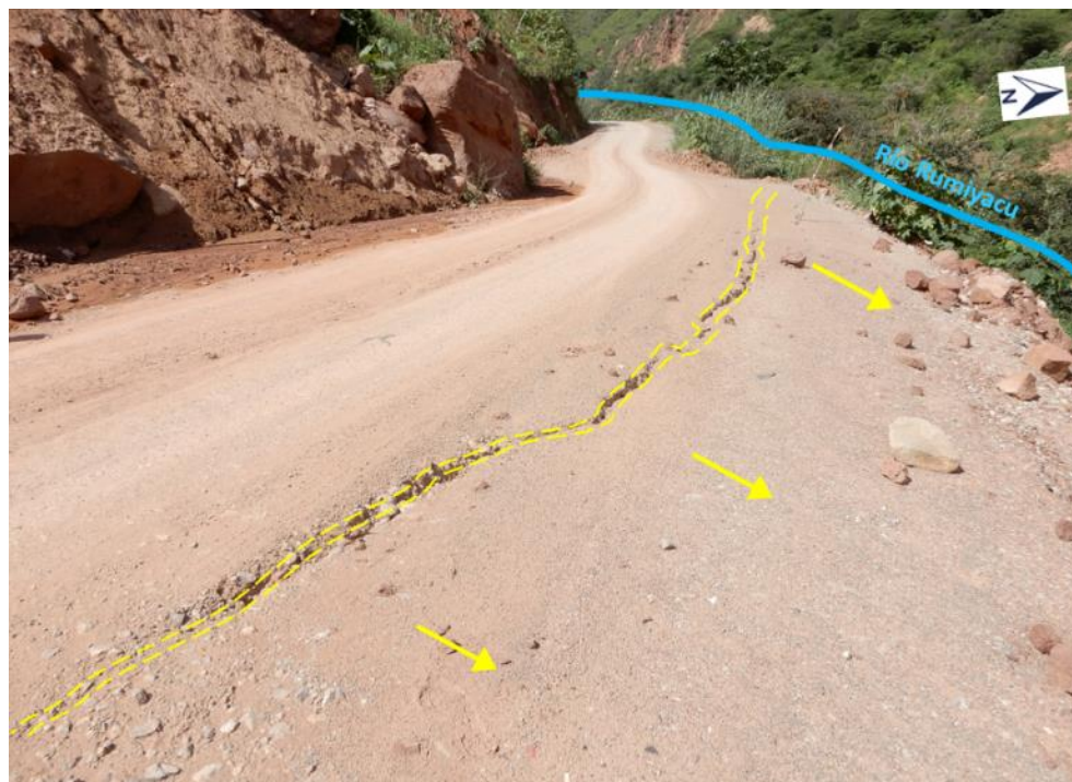
Figura12. Vía carrozable reconstruida con agrietamientos.
