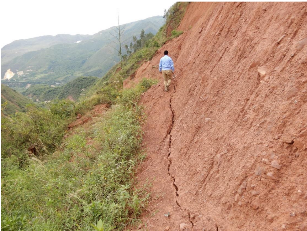
Fotografía 3. Se observa agrietamientos en la parte media del deslizamiento, con una longitud de 12 m y ancho de 5 a 10 cm.
