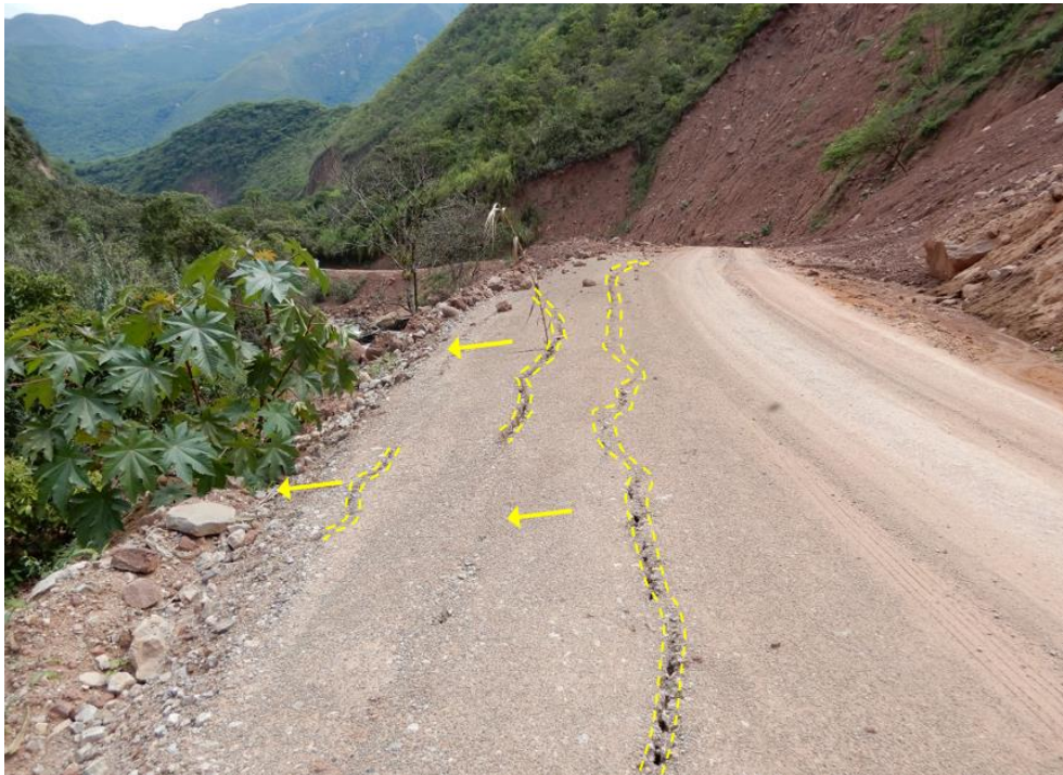
Figura 13. Vía afectada, los agrietamientos están paralelos a la dirección del río.
