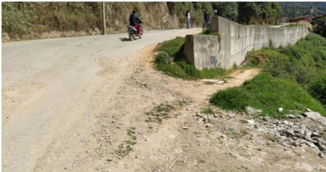
Fotografía 2. Tramo de carretera de aproximadamente 130 m, con evidencias de hundimiento (Coordenadas UTM (WGS 84): 385476 E, 8909237 S, a 2568 m s.n.m.)
