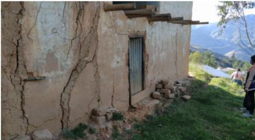
Fotografía 4. Vivienda con agrietamientos en muros y suelos (Coordenadas UTM (WGS 84): 3854627E, 8909292 S, a 2553 m s.n.m.)
