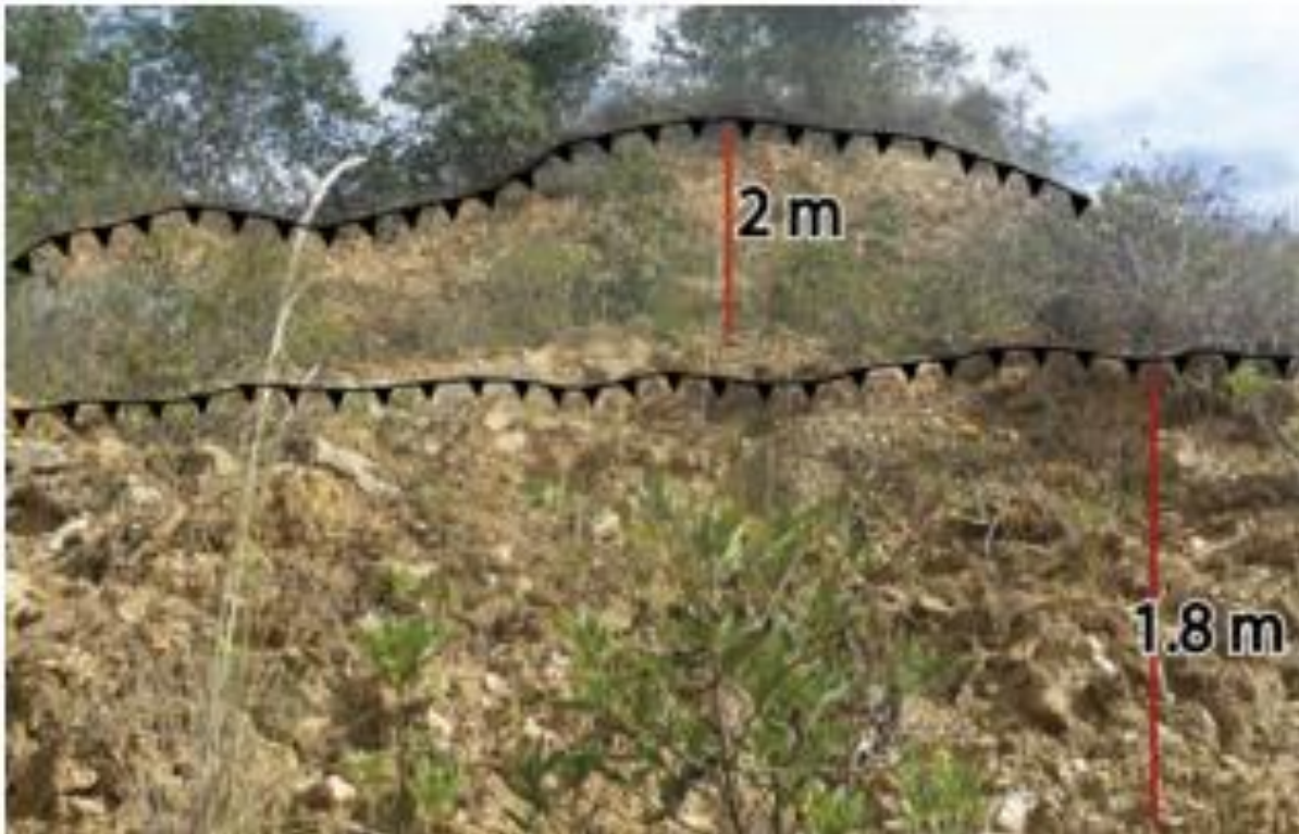
Figura 25. Muestra los escarpes secundarios del deslizamiento Cochapampa.
