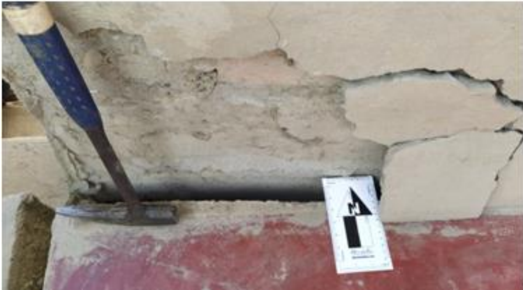
Fotografía 3. Vivienda con agrietamientos en muros y suelos (Coordenadas UTM (WGS 84): 385667E, 8909338 S, a 2525 m s.n.m.)
