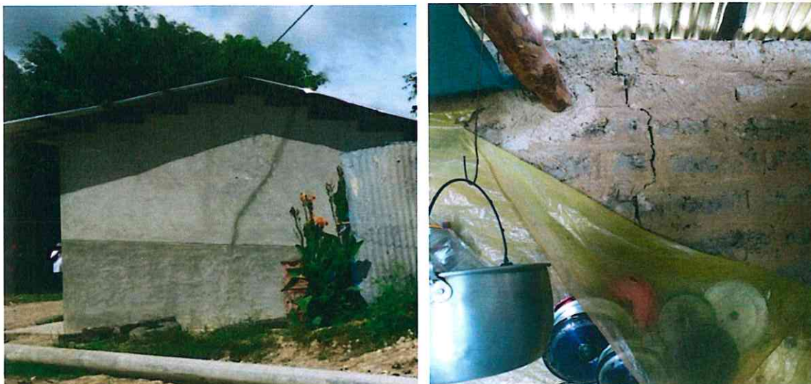
Fotos 36 y 37. Agrietamientos en las paredes de viviendas, de la calle Mesones Muro.
