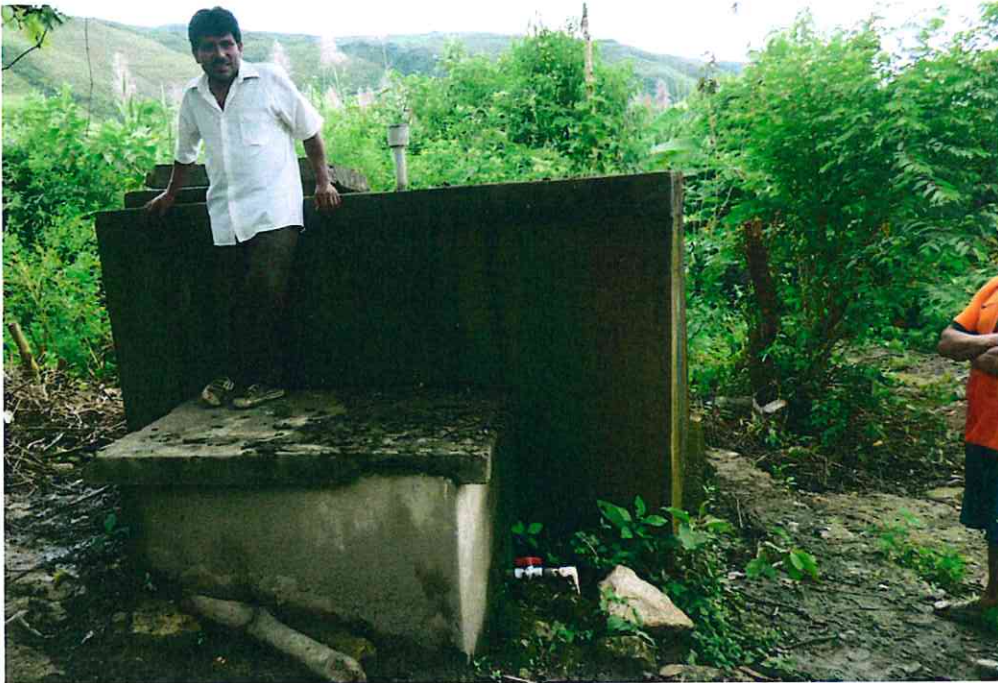
Foto 28. Tanque de agua ubicado en la parte superior del deslizamiento.
