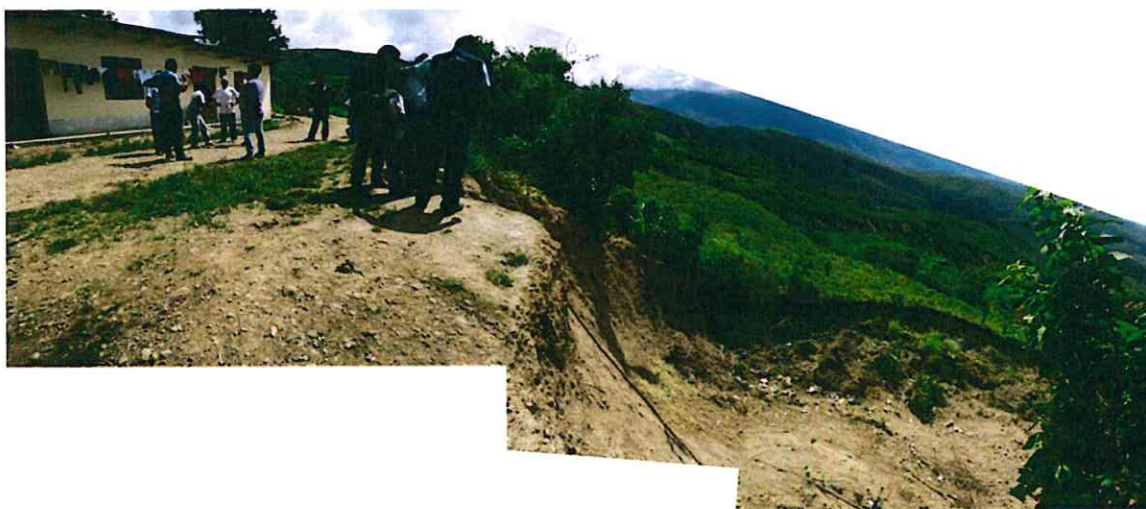
Foto 34. Proceso de erosión en cárcavas, en el lado lateral derecho se observa derrumbes, lo cual está incrementando su ensanche. Vista cercana a las viviendas de la Calle Mesones Muro.
