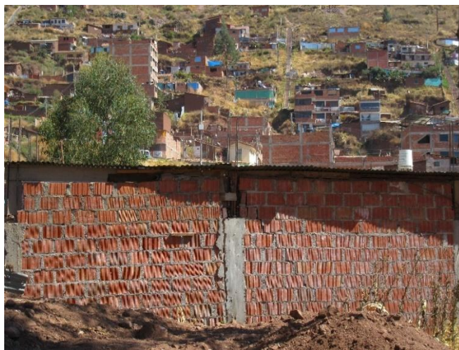
Fotografía 19: Evidencias actual del fallamiento en la estructura de la vivienda por la propagación lateral lenta en zona de cárcavas rellenadas
