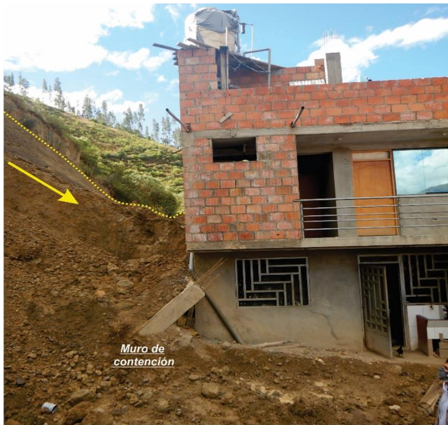
Figura 16. Se observa el muro de contención inclinado, producto del empuje del material del deslizamiento, instalado hace dos años atrás.
