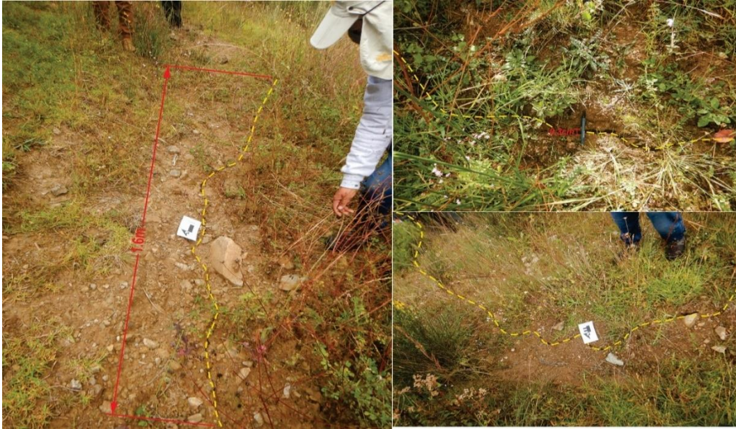
Figura 15. Vista con dirección norte específicamente a 25 m de la escarpa principal, donde se identificaron agrietamientos en algunos puntos, las mismas que están cubiertas por vegetación.
