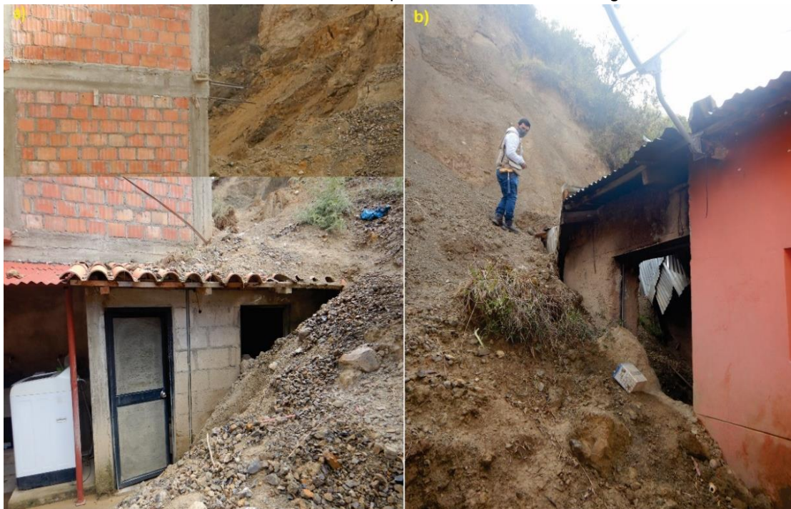
Figura 19. En la vivienda B, se observaron afectaciones a) servicio higiénico (construcción de bloques), b) ambiente utilizado como cocina, construcción de adobe, es aquí donde el deslizamiento destruyo parte del techo; actualmente este ambiente esta deshabitado.
