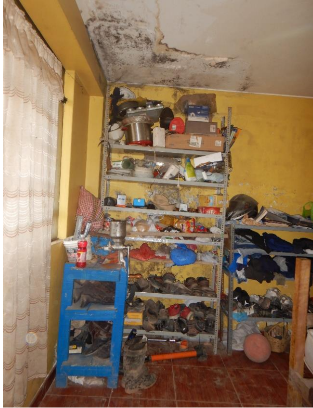
Fotografía 2. Se observa humedad en las paredes de la vivienda (A), actualmente está habitación se encuentra desocupada, como medida de seguridad.
