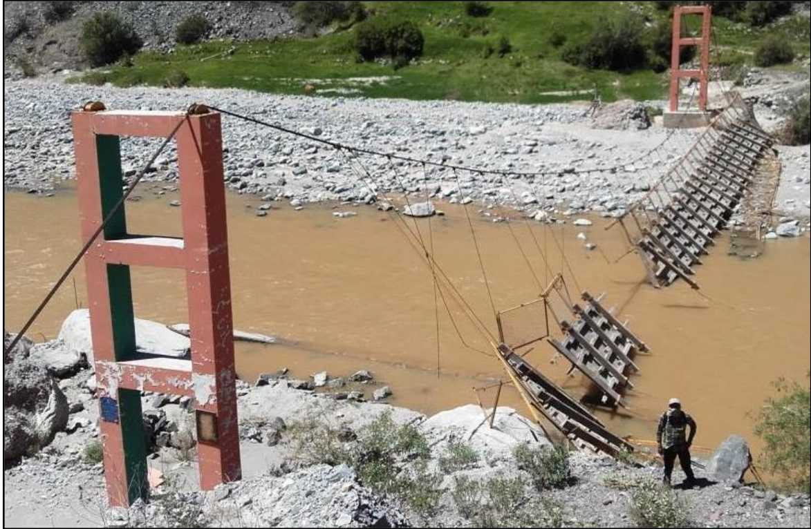
Figura 10. Puente peatonal de 50 m de largo destruido durante el desembalse de la laguna formada en el río Tambo el día 13 de febrero 2016. Tomado del informe técnico A6745, (coordenadas UTM E: 792762, N: 8335346).
