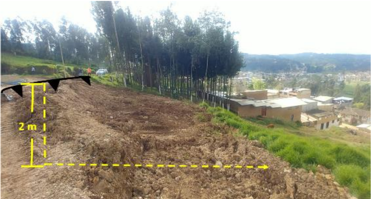
Figura 12. Escarpe del deslizamiento reactivado, desplazamiento vertical de aproximadamente de 2 m.
