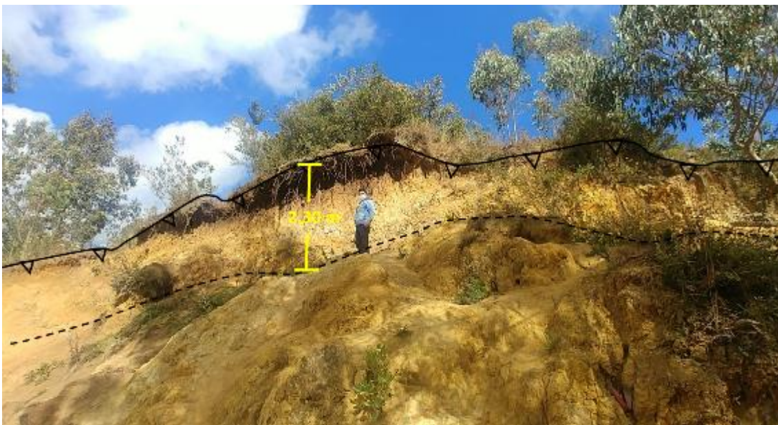
Figura 9. Escarpe de deslizamiento antiguo ubicado al este del sector evaluado, desplazamiento vertical de 2.30 m
