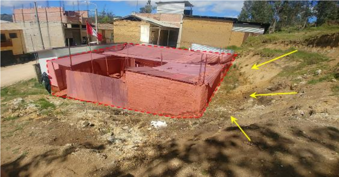
Figura 15. Se puede apreciar la vivienda que fue destruida a consecuencia del desplazamiento del material, que llegó hasta la avenida 15 de Agosto.
