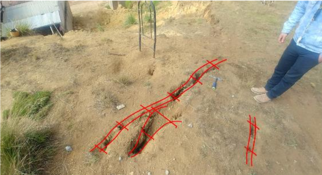
Figura 10. Se pueden apreciar grietas en el cuerpo del deslizamiento sobre viviendas de la carretera a Conday.
