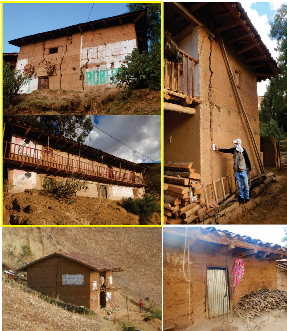
Figura 20. Estado actual de algunas viviendas, de las cuales dos se encuentra deshabitados como medida de seguridad (delimitado con una línea de color amarillo).
