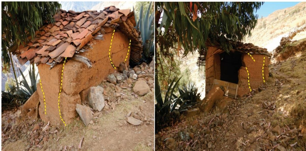
Figura 12. Se observa el servicio higiénico afectado, el cual presenta agrietamientos en dos caras. (grietas delimitadas con líneas punteadas de color amarillo).
