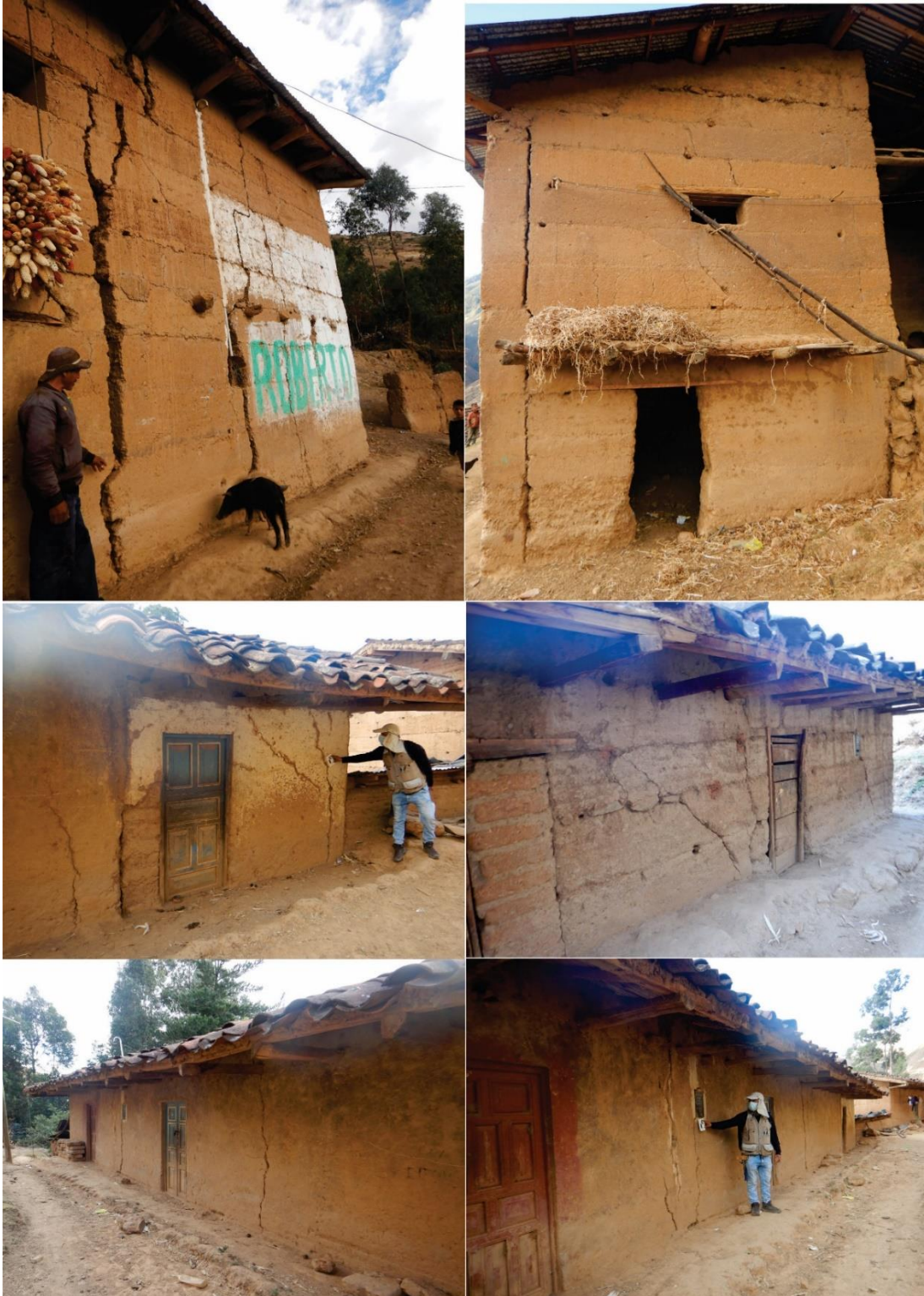
Figura 18. Vista donde se aprecia agrietamientos en paredes de adobe de las viviendas localizadas dentro del cuerpo desplazado, cabe mencionar que estas grietas tienen aberturas de hasta 0.20 cm, profundidad de 0.20 m y con longitudes de hasta 4 m, algunas viviendas sellaron dichas grietas; per esta volvió a generarse.
