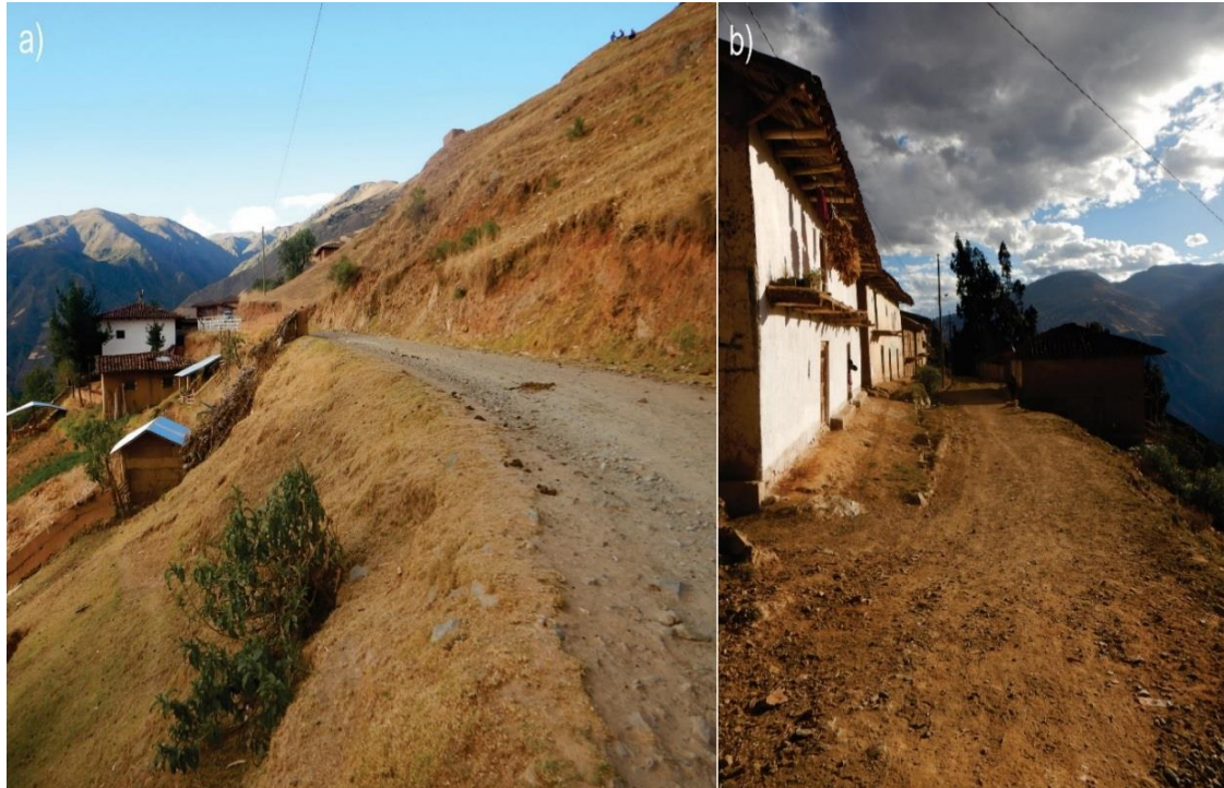
Figura 19. Vista donde se puede observar la trocha carrozable: a) vista con dirección al oeste donde se observa que la trocha no tuvo variación alguna, b) vista al este, donde se generó el asentamiento de 0.70 a 1 m y empuje de la trocha, según información de los pobladores, fue refaccionada.
