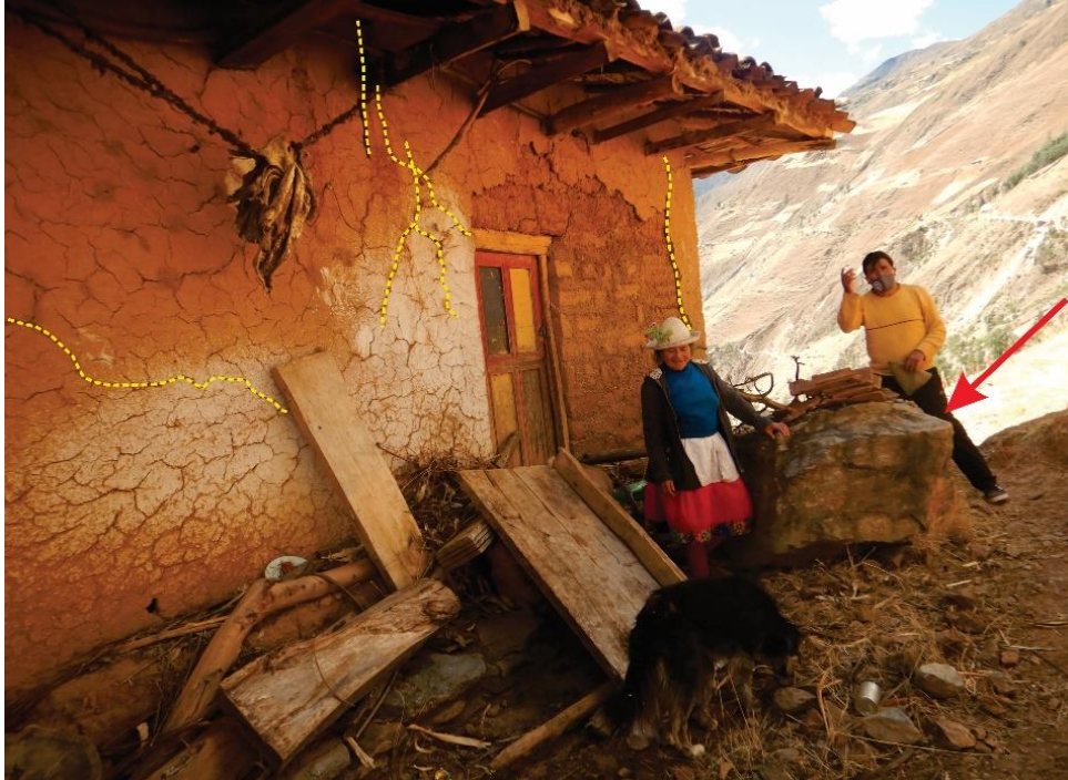
Figura 13. Vista del bloque de roca de 1.5 m de diámetro, que generó el colapso parcial de la vivienda.
