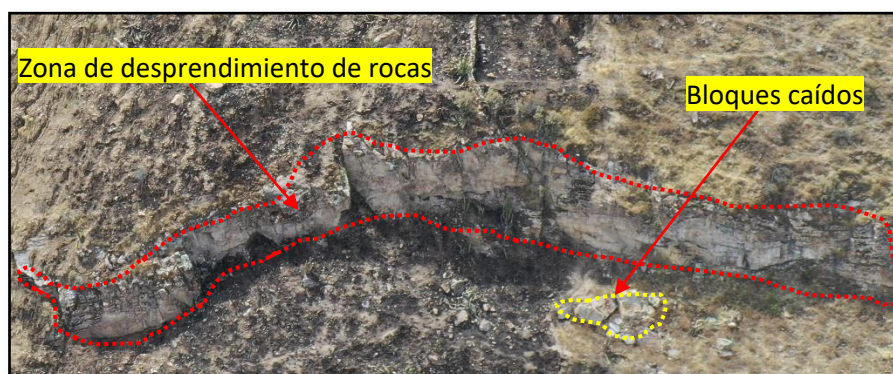
Figura 12. Bloques desprendidos en Pachamalqui (coordenadas UTM WGS 223235E, 8273956N).
