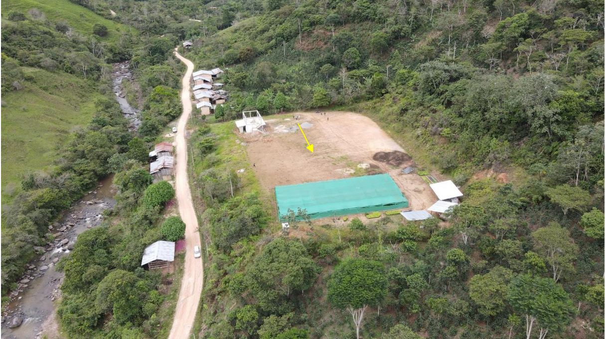
Figura 11. Excavación sobre limolitas beige de la Formación Pozo para conformar la explanada para la construcción del colegio del centro poblado Nuevo San Miguel.
