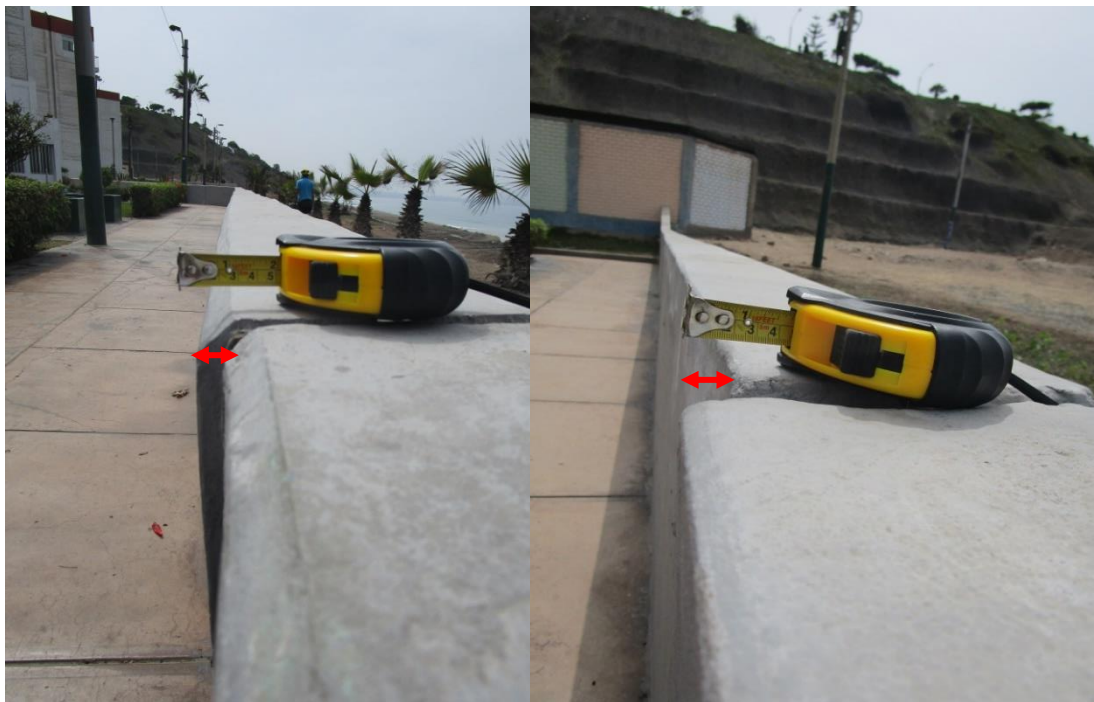
Figura 44. ... Continuación.../. Imágenes de desplazamiento de 3 cm en el muro de concreto que circunda el Conjunto Residencial Marbella-ENACE, distrito Magdalena del Mar.
