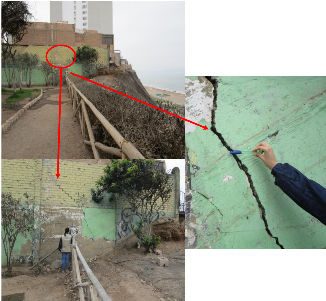
Figura 44. Imágenes de las grietas observadas en la pared de vivienda (abertura de 3 cm), ubicada en el extremo norte del parque Grau, del ACV en el distrito de Magdalena del Mar.
