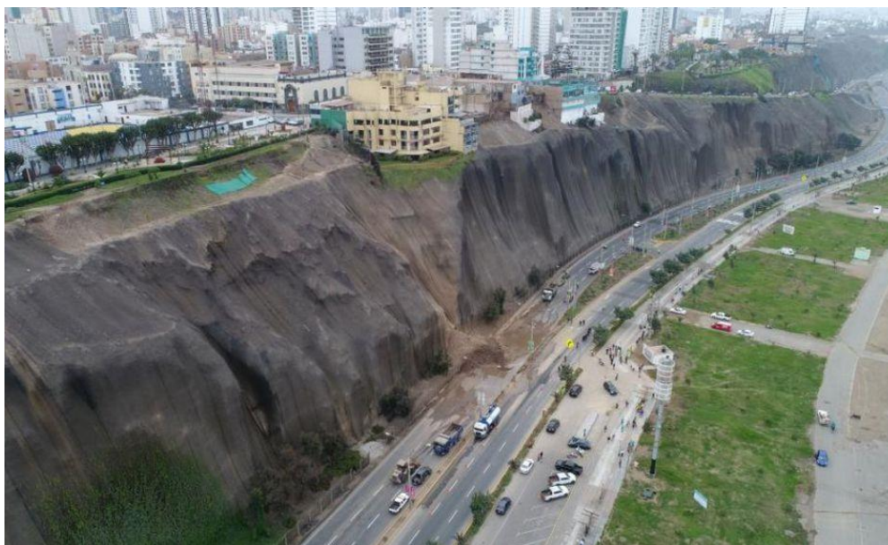
Figura 2. Deslizamiento ocurrido el 08 de agosto de 2019 en el ACV (Fuente Diario Gestión).
