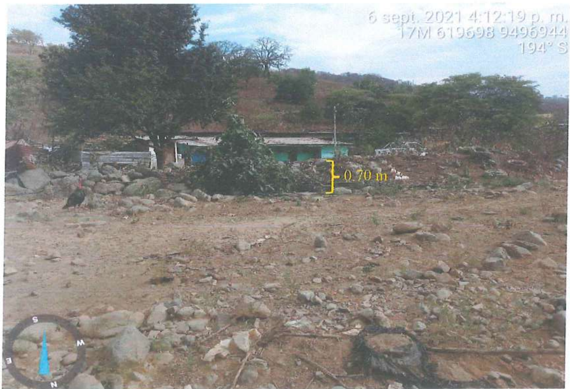
Figura 18.- Dique de encauzamiento de 0.70 m de altura que ante el incremento del caudal de la quebrada podría ser afectado y generar inundaciones en la zona urbana
