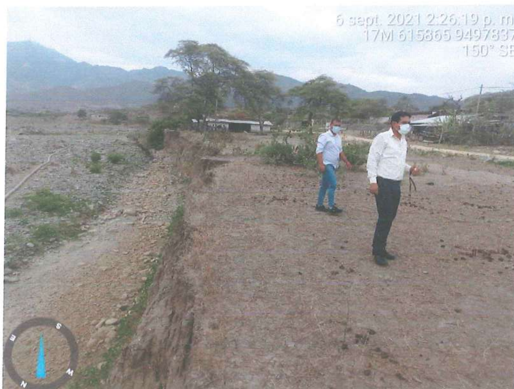
Figura 11.- Vista de vivienda cercana a talud que se viene erosionado por el cauce de la quebrada Suyo
