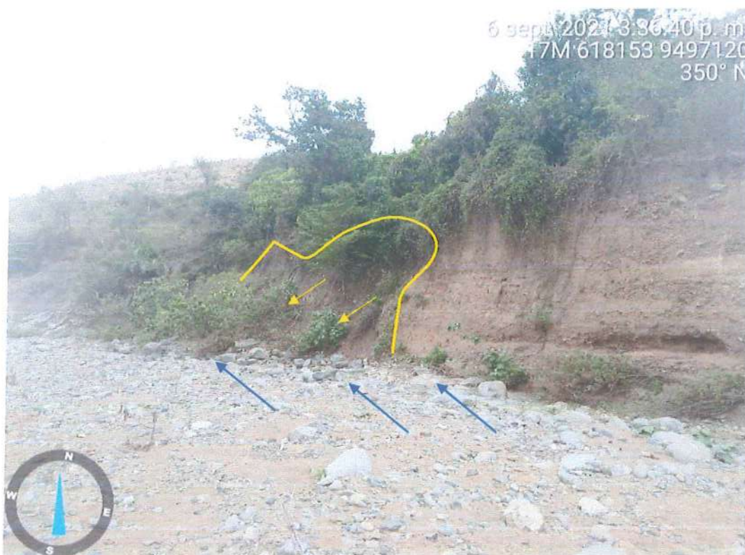
Figura 15.- Derrumbe (línea amarilla) en ladera debido a erosión fluvial (flechas azules) al pie de la ladera del margen derecho de la quebrada Suyo. El derrumbe afectó un tramo de 100 m del canal de irrigación situado en la parte alta de la ladera.
