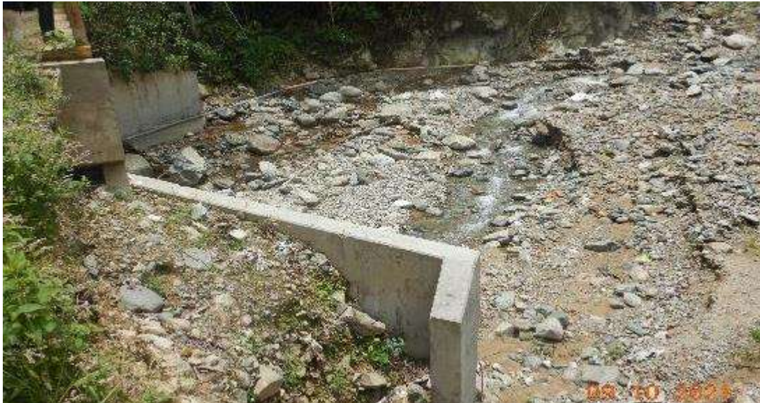
Fotografía 14. Erosión de la plataforma del puente Periaventina y acumulación de flujo de detritos.
