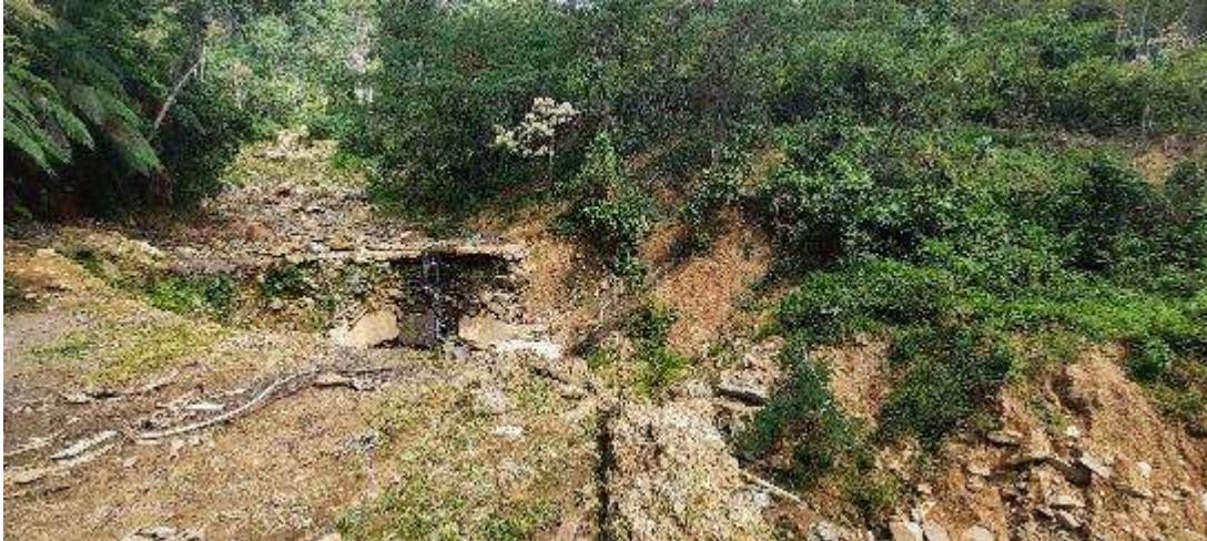
Fotografía 20: Infraestructura destruida (carreta de trocha y el badén)
