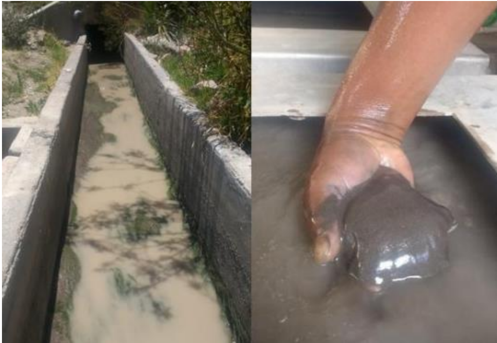
Figura 32: Colmatación de los canales de la Planta Hidroeléctrica Lluta y Llucta reportado en el 2020.
