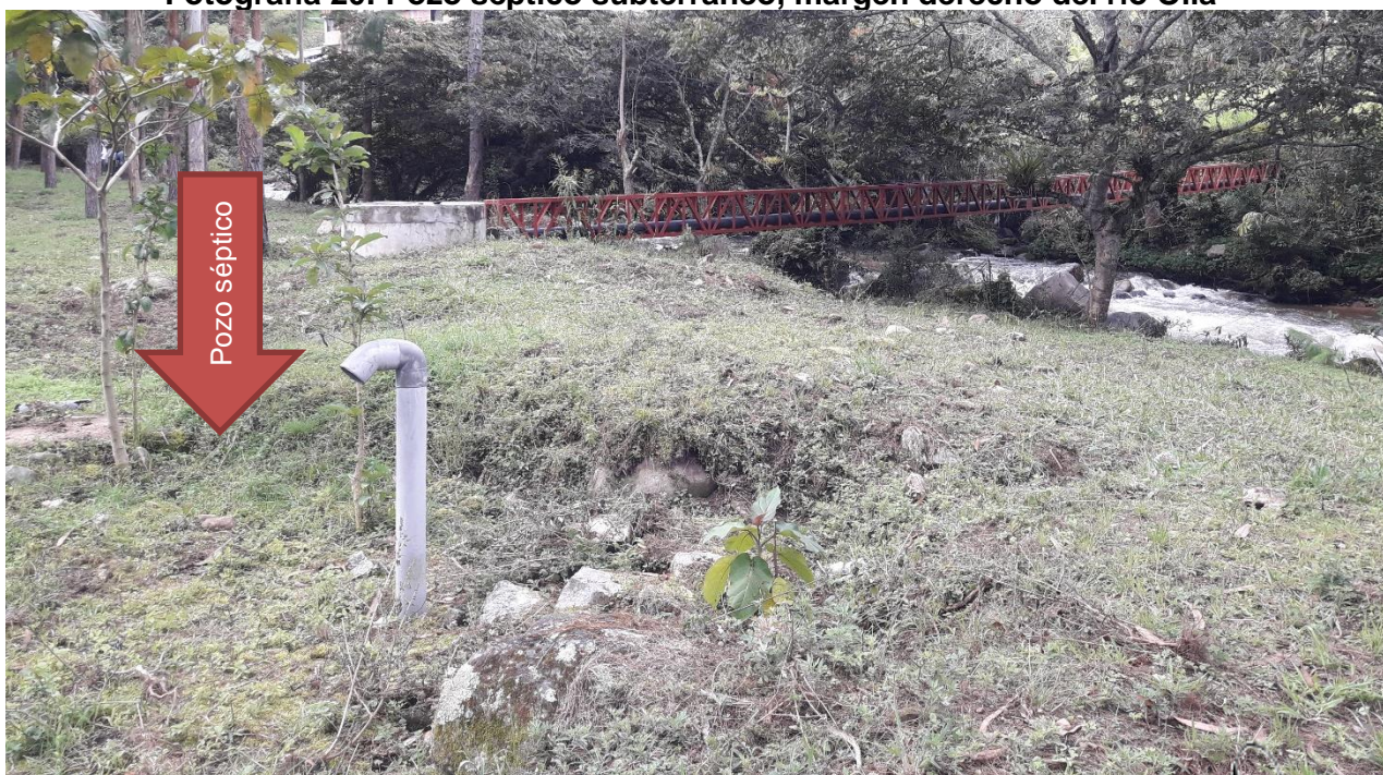
Fotografía 20: Pozo séptico subterráneo, margen derecho del río Olia
